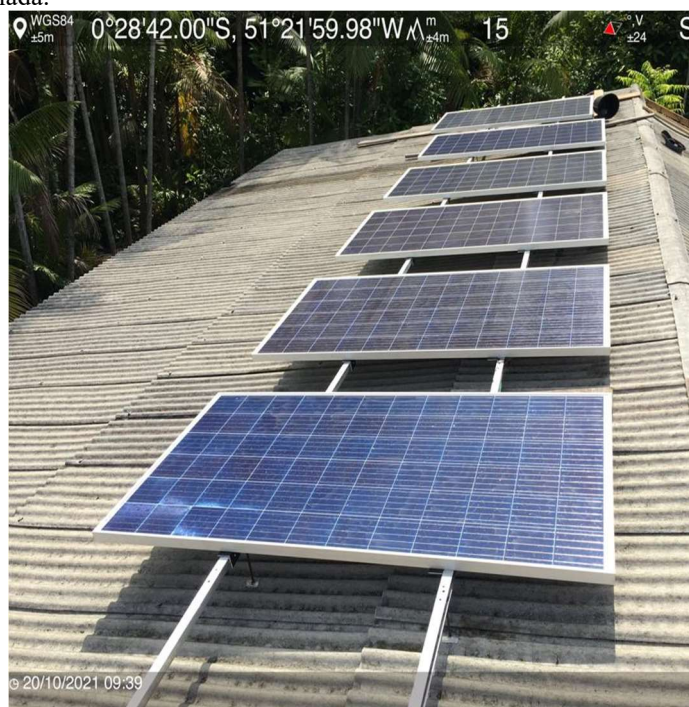
Figura 4 - Gerador fotovoltaico instalado na sede da ATAIC.
