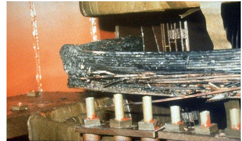
Verbrannter Transformator durch einen Sonnensturm Salem Kernkraftwerk New Jersey, USA (1989)
