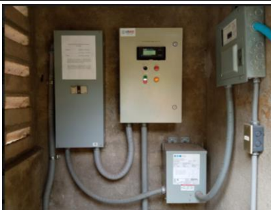
BOMBAS DE AGUA
