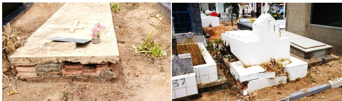
Figura 6: Cemitério Urbano Público Municipal Nossa Senhora da Conceição – Boa Vista/RR: má confecção e manutenção dos jazigos
