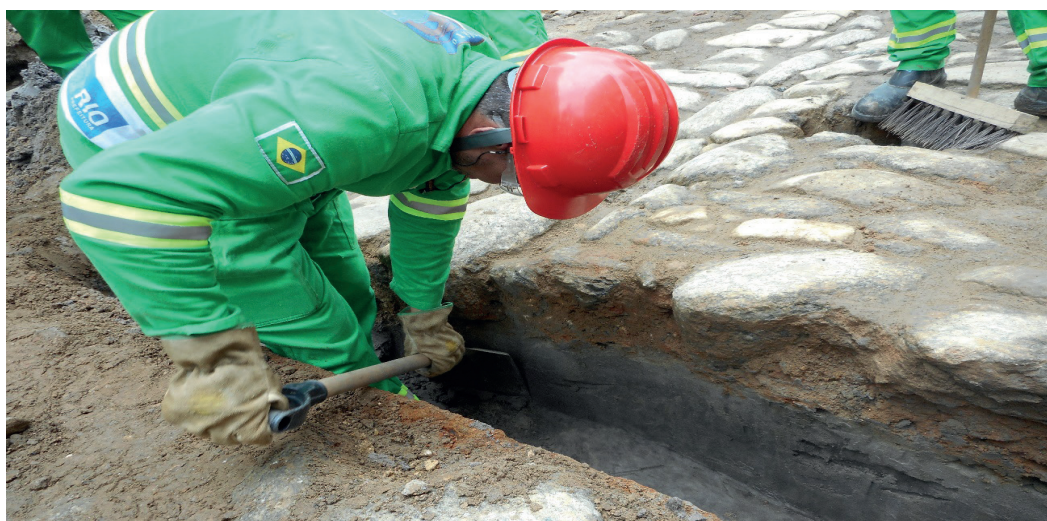
Figura 3: Processo de retificação de seção na trincheira aberta na área anteriormente danificada pela instalação de um cano de gás. Fonte: Fotografia de Diogo de Souza Borges.
