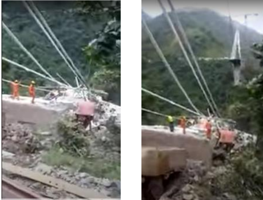
Gráfica 25 Fotografía del desplome del puente Chirajara
