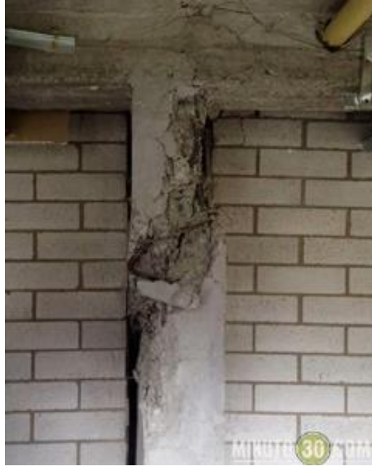
Gráfica 12 Fotografía de las columnas las cuales fueron una de las causas del desplome
