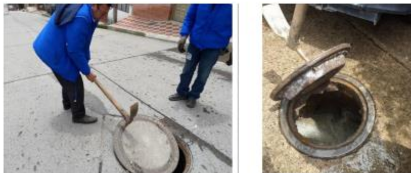
Ilustración 14. Pozo de inspección. Fuente: Quintero. 2022. p.30
