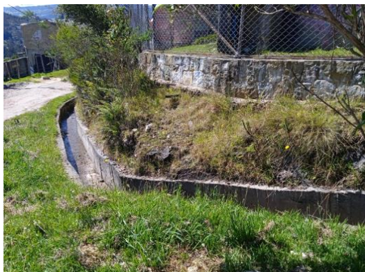
Cuneta de recolección de Aguas Lluvias
