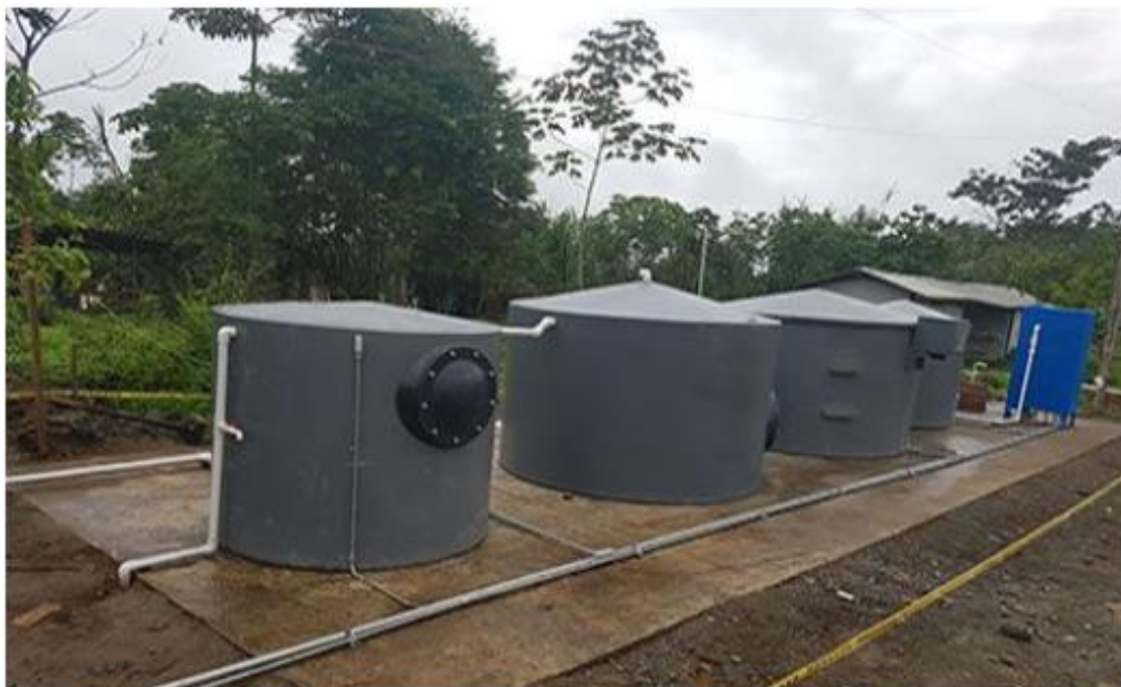
Ilustración 9. PTAR. Fuente: Fibras y Normas de Colombia S.A.S. (s.f.) https://blog.fibrasynormasdecolombia.com/procesos-de-aguas-residuales-ptar-definicion-tipos-etapas-del-proceso-conclusiones/
