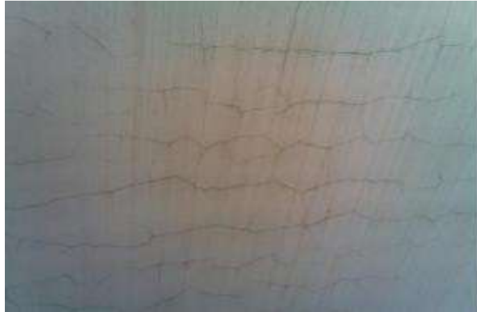
Figura 10. Concreto expuesto a temperaturas de 300 a 400 °C.
