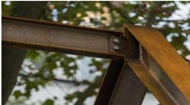
Figura 14. Acero expuesto a temperaturas de 400 a 500 °C.
