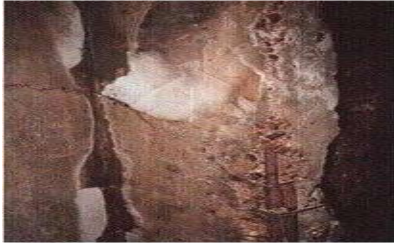
Figura 12. Concreto expuesto a temperaturas de 600 a 950 °C.
