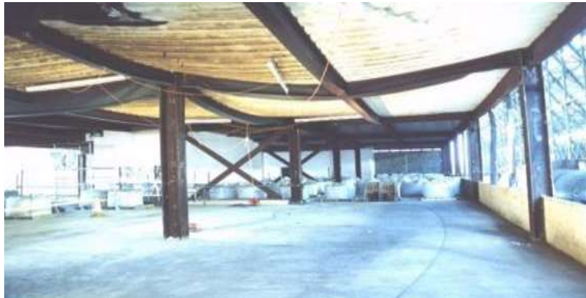
Figura 17. Acero expuesto a temperaturas de 700 a 1200 °C.
