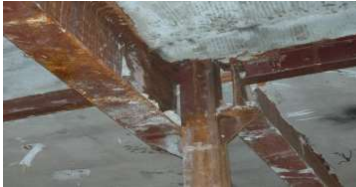
Figura 15. Acero expuesto a temperaturas de 500 a 600 °C.
