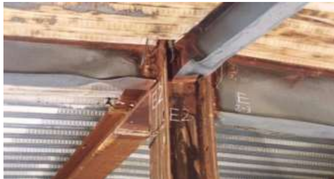
Figura 16. Acero expuesto a temperaturas de 600 a 700 °C.
