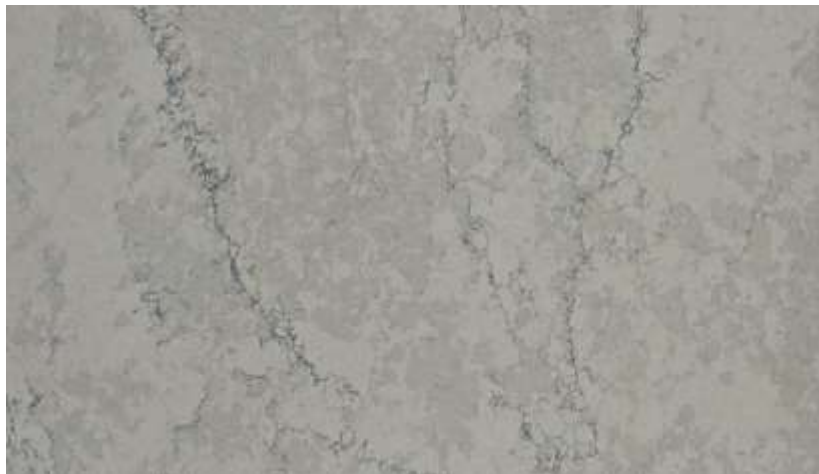
Figura 9. Concreto expuesto a temperaturas de 200 a 300 °C.
