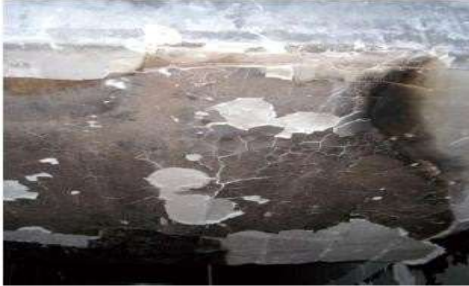
Figura 11. Concreto expuesto a temperaturas de 400 a 600 °C.
