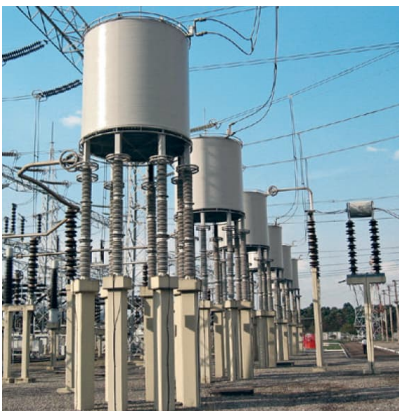
Imagen 2. Reactor seco de una bobina en Subestación.
