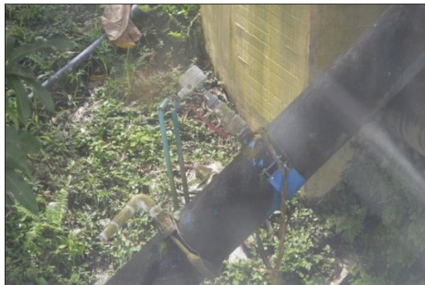
ILUSTRACIÓN 14 Macromedidor de entrada
