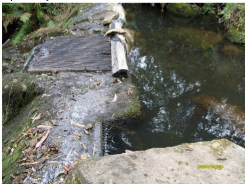
Figura 7. Captación Quebrada San Lorenzo.
