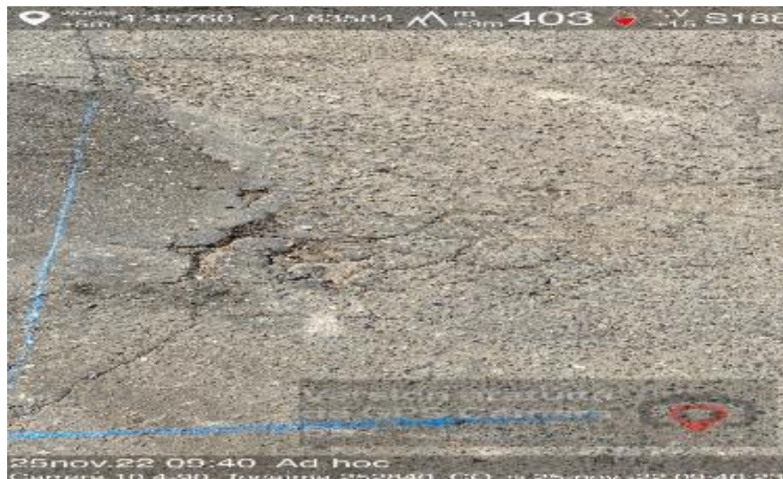
Ilustración 12 Fisuras transversales y Longitudinales de la vía fuente: elaboración propia
