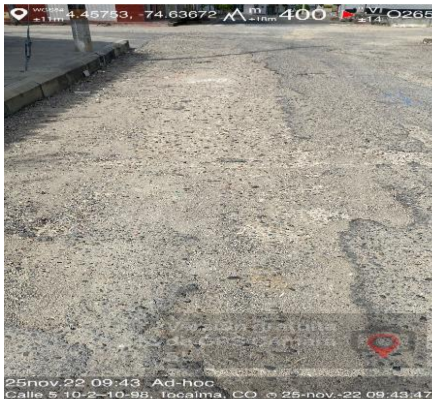
Ilustración 16 Falla por descaramiento fuente: elaboración propia
