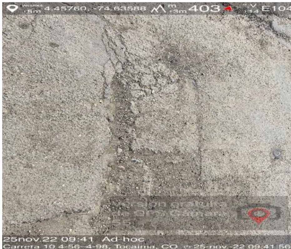
Ilustración 13 Piel de cocodrilo en la vía Fuente: elaboración propia
