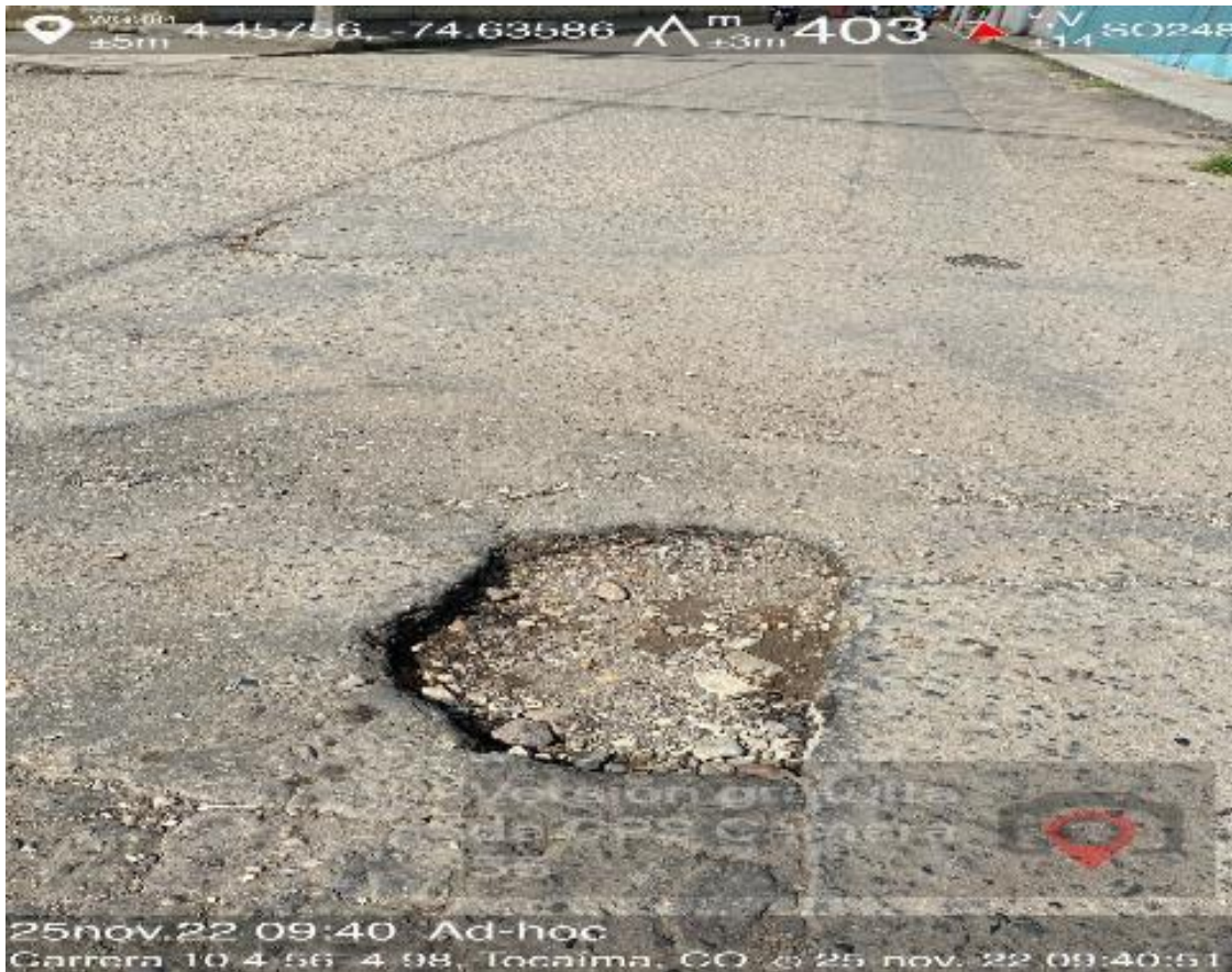
Ilustración 17 Baches en el tramo vial fuente: de elaboración propia
