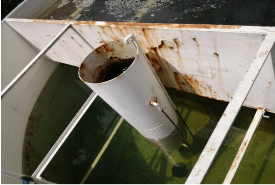
Ilustración 33. Filtración planta1. Fuente: propia
