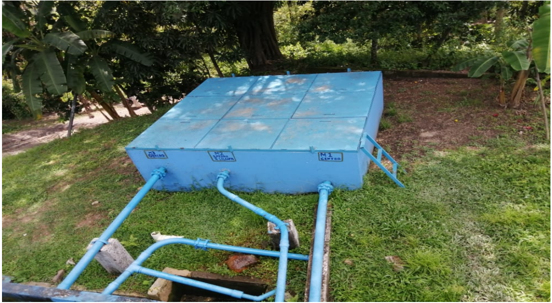
Ilustración 37. Caja de macro medidores de salida de agua tratada. Fuente: propia
