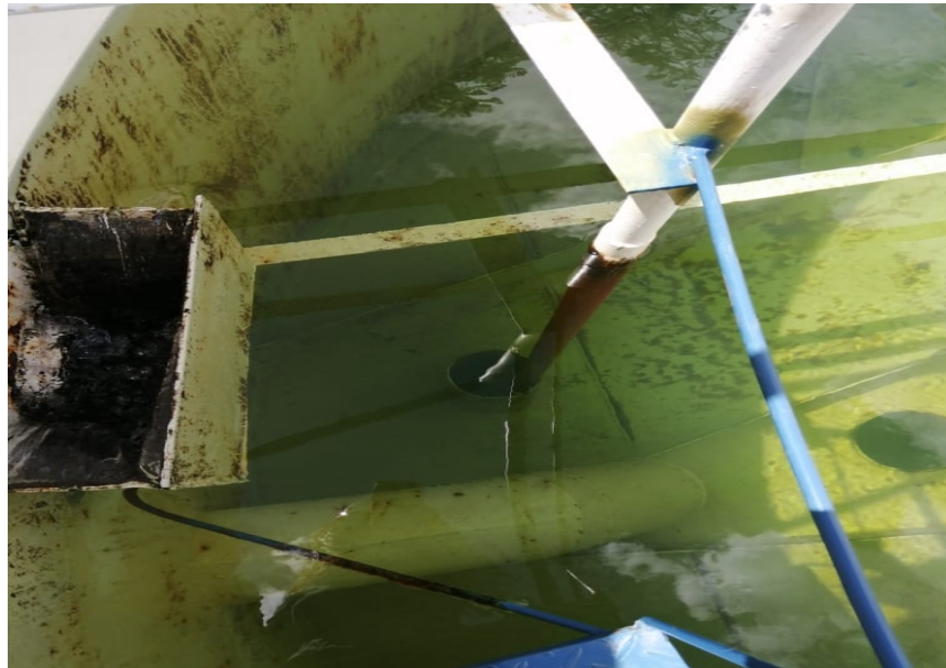
Ilustración 34. Canaleta parshal 1. Fuente: propia
