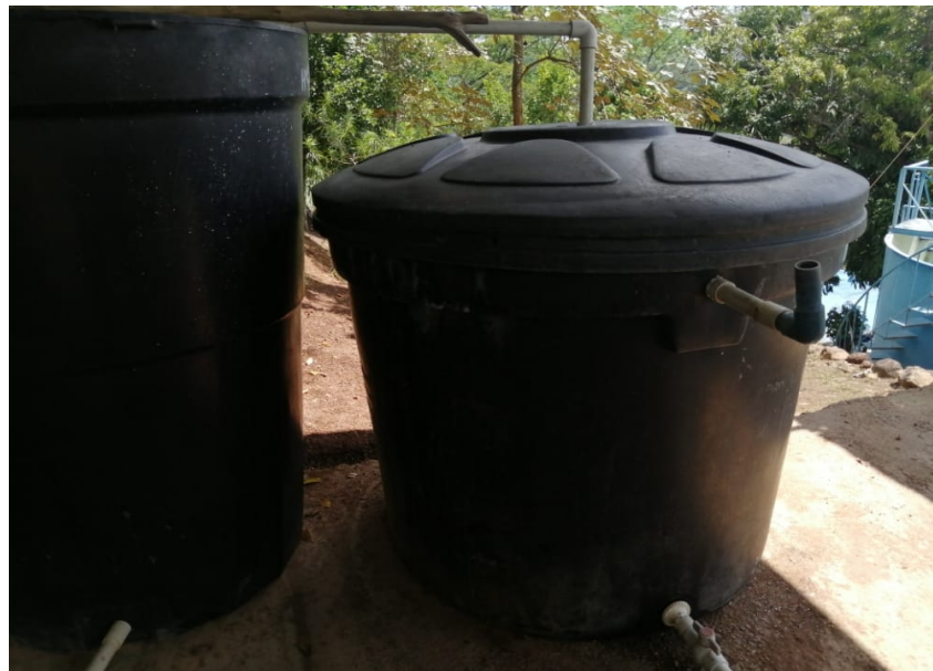
Ilustración 20. Almacenamiento agua cruda. Fuente: propia
