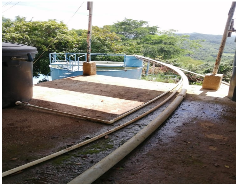
Ilustración 30. Descargue de coagulantes sulfato de aluminio. Fuente: propia
