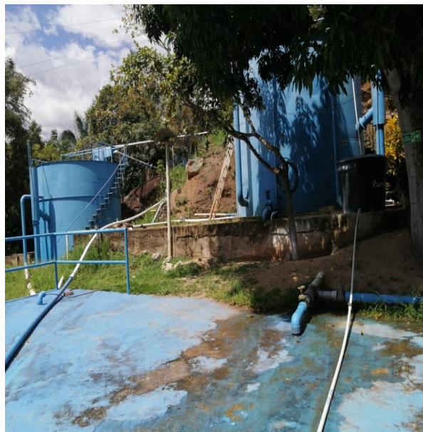
Ilustración 15. Visita a la PTAP. Fuente: propia
