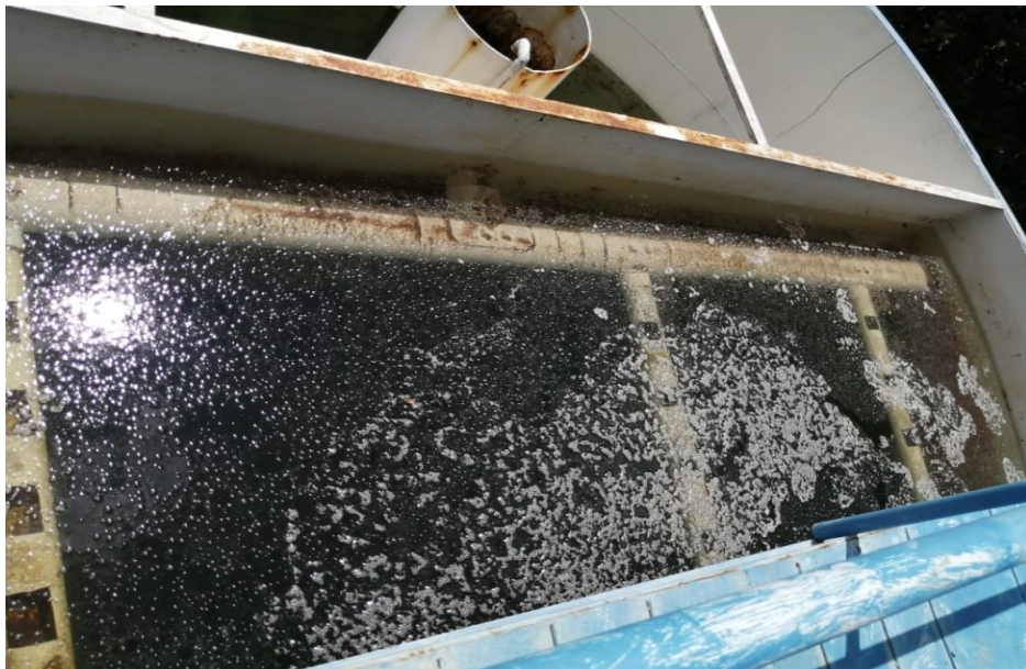
Ilustración 32. Floculación planta 1. Fuente: propia
