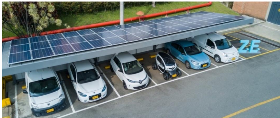
Figura 6. Parqueadero solar instalado en la compañía Renault-Sofasa. Fuente: Placer Vial (s.f.)
