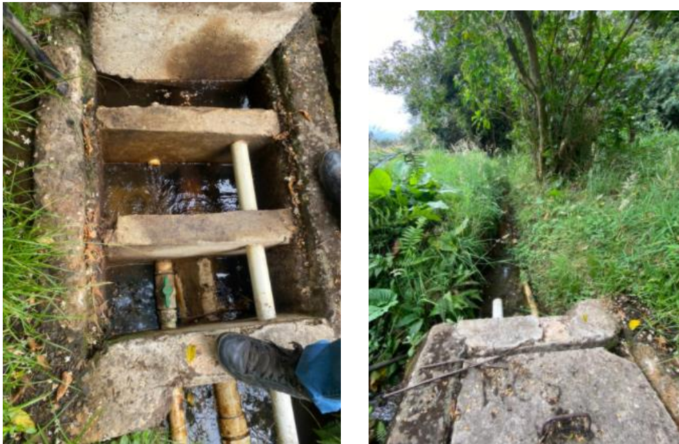
Ilustración 11: Tubería de salida de la bocatoma
