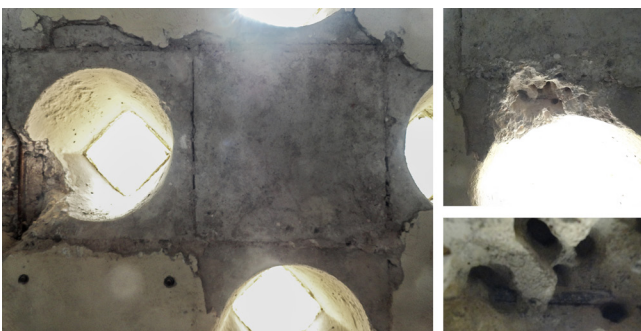
Figura 13: Catas en las piezas prefabricadas de Escombreras II realizadas por la compañía al estudiar la posibilidad de su demolición en 2021. Fuente: los autores.
