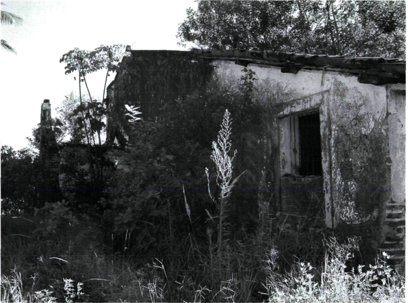
Afb. 2. O Carmelo, een oud toevluchtsoord in vervallen staat verdient het om gerestaureerd te worden (foto auteur).
