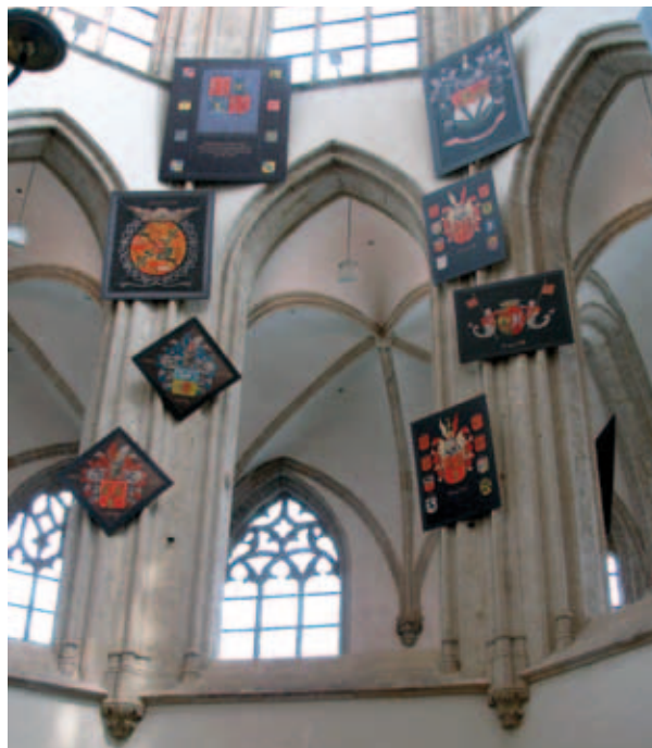
10. De huidige scheibogen van de koorapsis met weggehakte profielen en ter hoogte van de afzaat de oorspronkelijke basementjes van de dagkantprofilering van de oorspronkelijke vensterramen (foto Frans Doperé)
