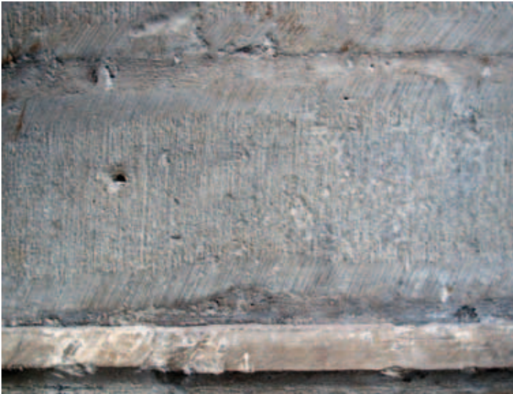
2. Fase I van de steenhouwchronologie voor witte kalkzandsteen op de zuidoostelijke vieringpijler. Op het middendeel van het gehouwen steenoppervlak komen verticale, scherp ingesneden parallelle lijnen voor. Deze zijn het resultaat van het gebruik van de steenbijl (zwaaiivlecht) of de polka. De randslag wordt gekenmerkt door fijne, zeer nauw op elkaar aansluitende streepjes. Deze zijn aangebracht met de beitel (foto Frans Doperé)
