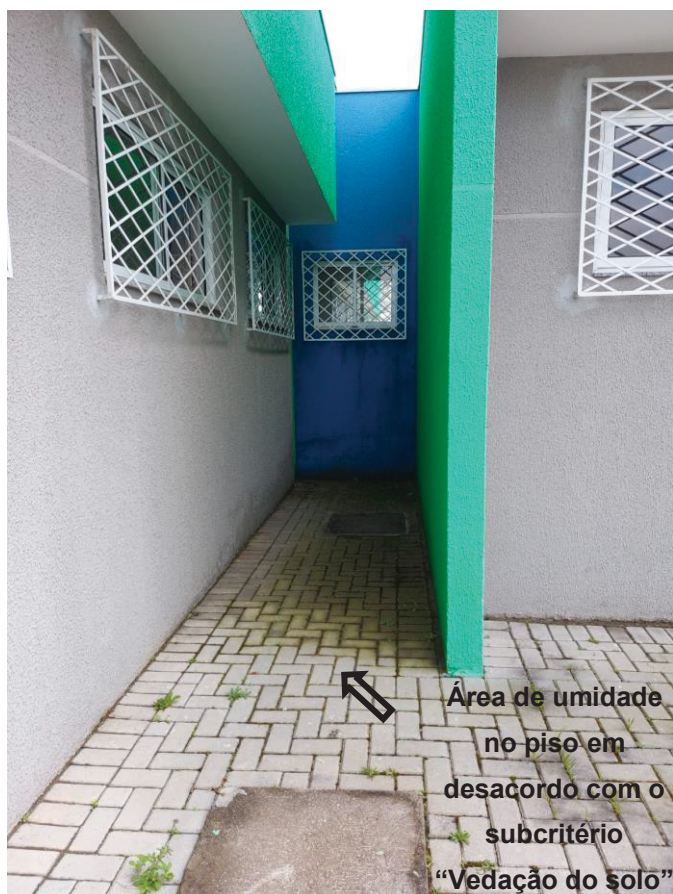
FIGURA 24 – REGISTRO FOTOGRÁFICO ÁREA ÚMIDA NO PISO DA UBS P3
