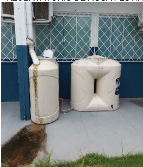
FIGURA 29 – RESERVATÓRIO DE ÁGUA PLUVIAL DA UBS P4
