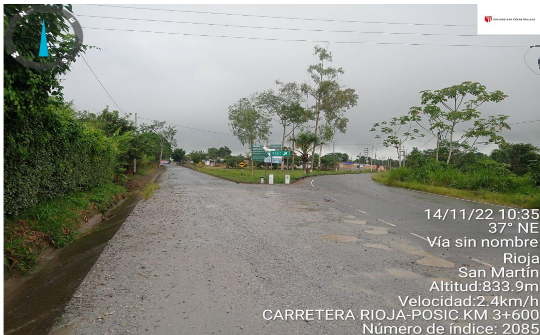
Figura 50: Vista del estado actual de tramo de carretera entre los pueblos vecinos Rioja – Posic KM 3+566 – presentando baches de áreas considerables
