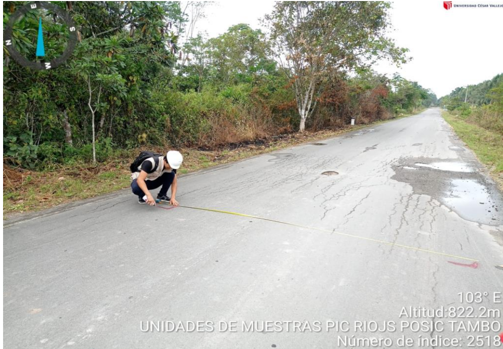
Figura 43: Vista del estado actual de tramo de carretera entre los pueblos vecinos POSIC – TAMBO KM 10+316 – medición de unidades de muestra - piel de cocodrilo, ahuellamiento, baches
