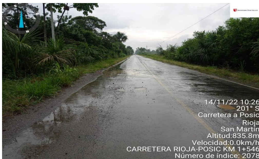
Figura 42: Vista del estado actual de tramo de carretera entre los pueblos vecinos Rioja – Posic KM 1+546 – presentando baches de áreas considerables y la acumulación de agua y la posible saturación del material
