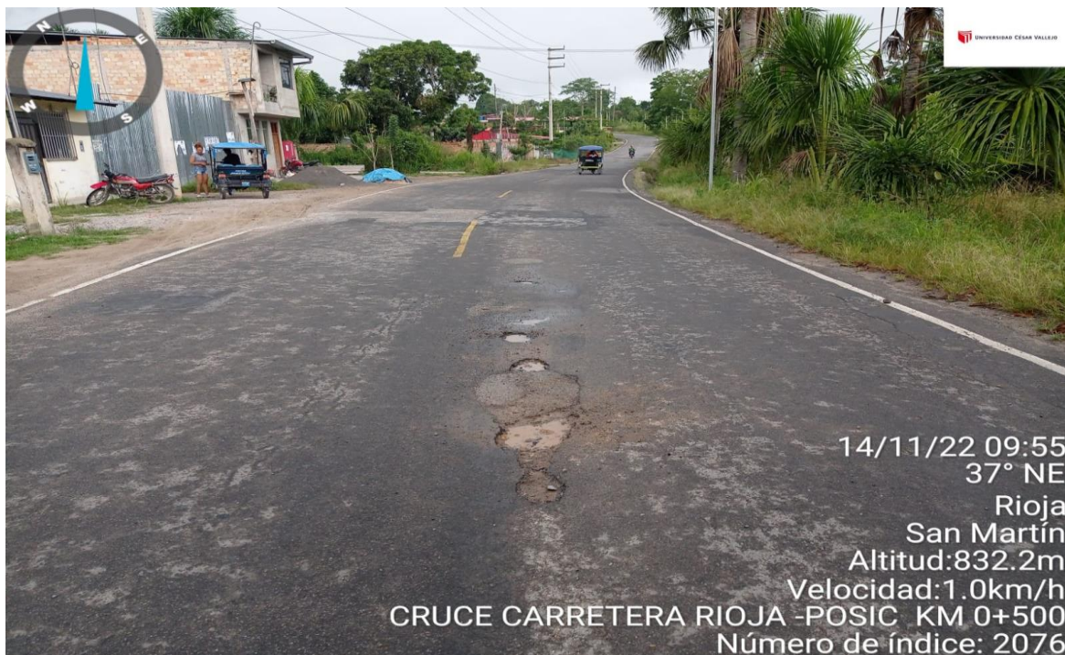
Figura 41: Vista del estado actual de tramo de carretera entre los pueblos vecinos Rioja – Posic KM 0+500 – presentando baches de áreas considerables
