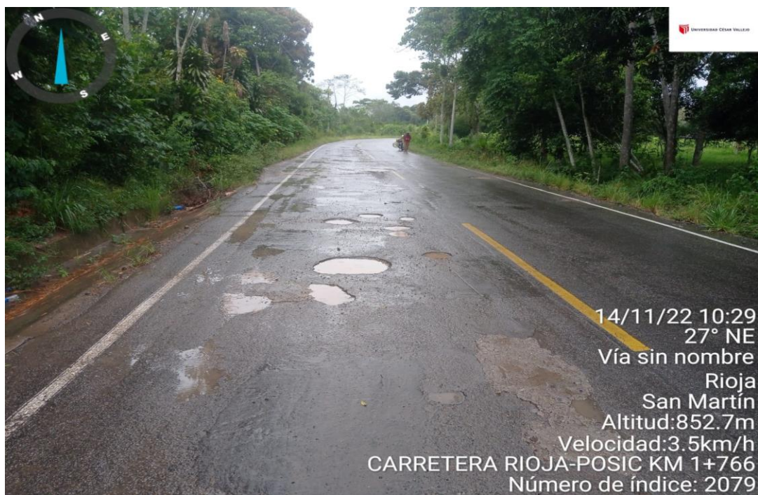
Figura 44: Vista del estado actual de tramo de carretera entre los pueblos vecinos Rioja – Posic KM 1+766 – presentando baches de áreas considerables
