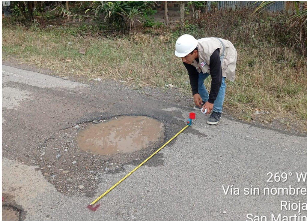
Figura 45: Vista del estado actual de tramo de carretera entre los pueblos vecinos POSIC – RIOJA KM 3+485 – medición de unidades de muestra - baches
