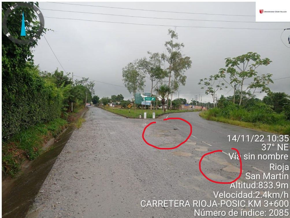
Figura 35. Vista del tramo de carretera dirección Posic -Tambo y unidades de inspección
