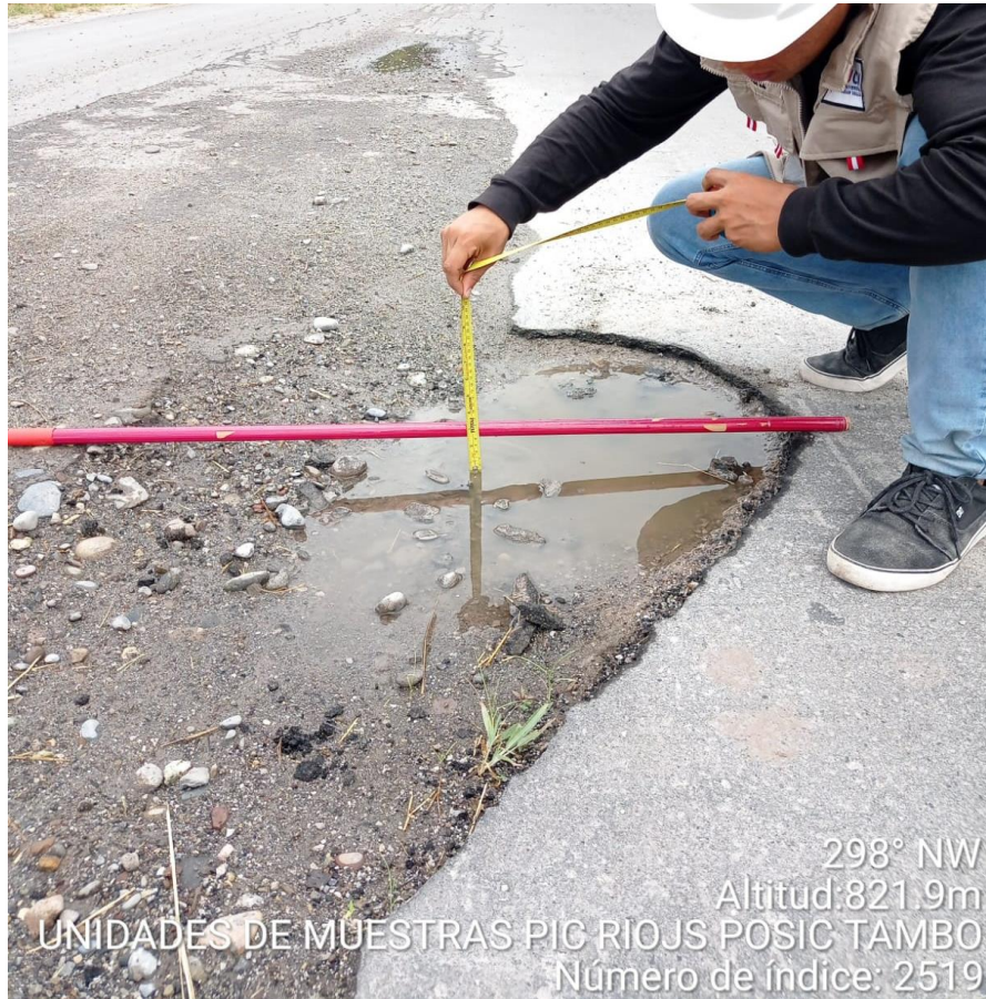
Figura 47: Vista del estado actual de tramo de carretera entre los pueblos vecinos POSIC – TAMBO KM 7+365 – medición de unidades de muestra, baches, hundimientos
