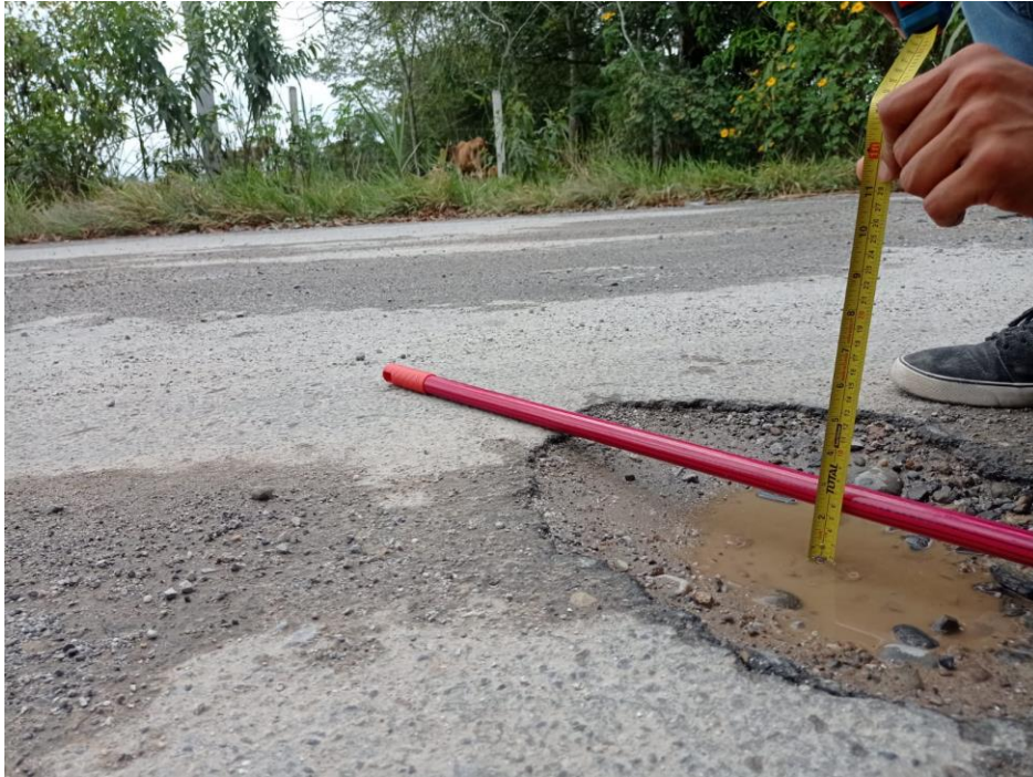
Figura 49: Vista del estado actual de tramo de carretera entre los pueblos vecinos POSIC – TAMBO KM 5+050 – medición de unidades de muestra, profundidad baches, lisuras de hundimientos
