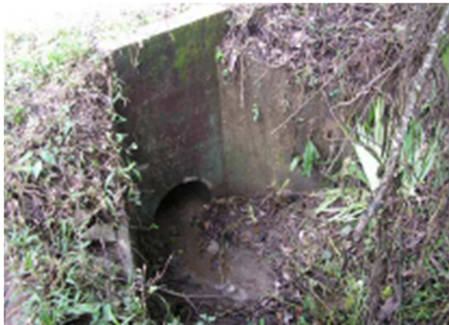
Figura No.3 Alcantarilla a ser desbloqueada
