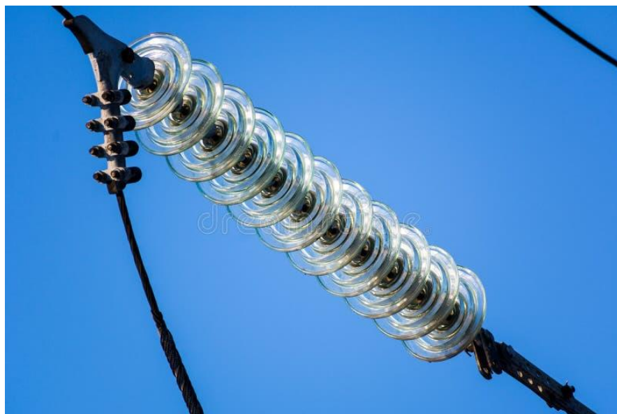
Figura 8 - Cadeia de isoladores de vidro [20].
