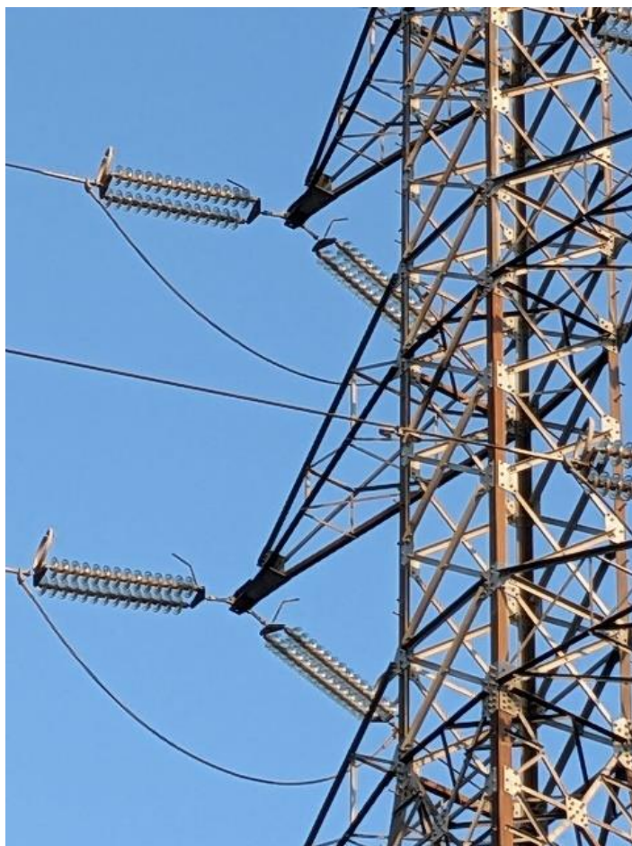
Figura 9 - Isoladores em amarração [fotografia do autor].
