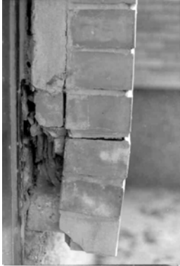
Slika 3: Pojava destrukcije zida
