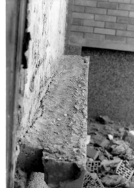
Slika 4: Pojava destrukcijabetonskog ispusta
