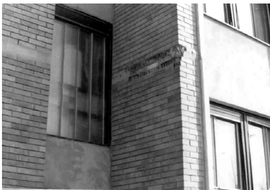
Slika 2: Pojava destrukcija opeka u zidu
