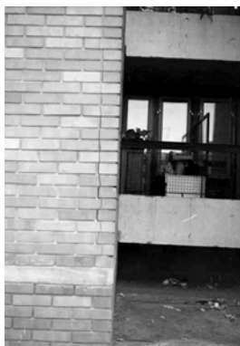
Slika 1: Pojava pukotina na opekama
