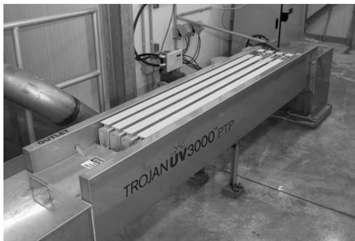
Figura 5.- Equipo de desinfección UV instalado en la planta de tratamiento ( www.trojanuv.com ).
