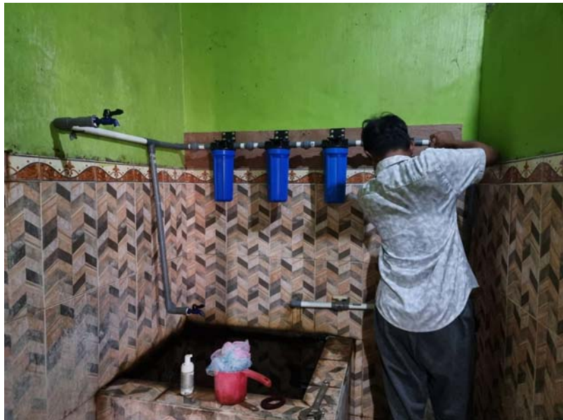
Gambar 6 Pemasangan alat Balam di Rumah Warga
