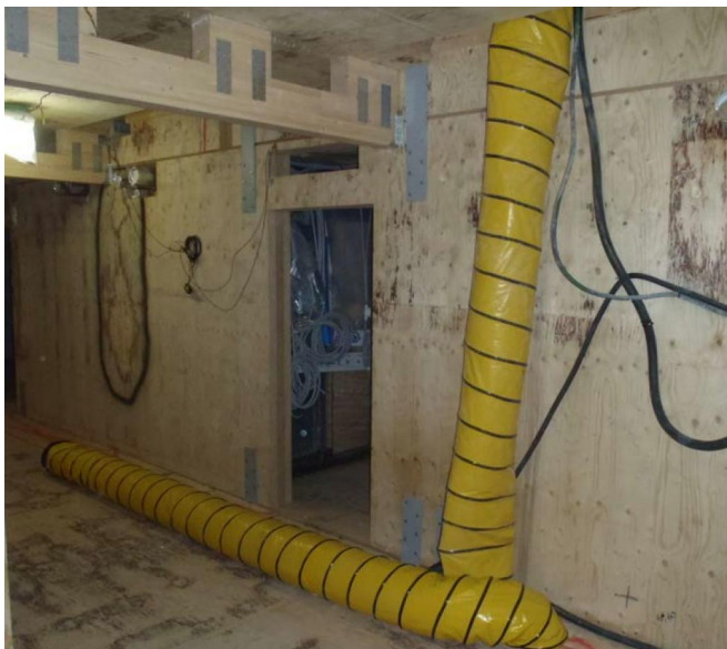
Kuva 3. Riittäväällä lämmityksellä ja ilmanvaihdolla nopeutetaan rakenteiden kuivumista. Ilmanvaihdon riittävyys varmistetaan ilman suhteellisen kosteuden mittaamisella, jonka tulisi olla 40-60% välillä.
