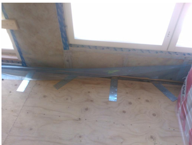
Kuva 4. Höyrynsulun ehjyys välipohjien kohdalla on haasteellista ulkoseinäelementtien kiinnikkeiden vuoksi. Höyrynsulku on otettava huomioon sekä rakenteiden liitosten suunnittelussa, että työjärjestyksiä suunniteltaessa.
