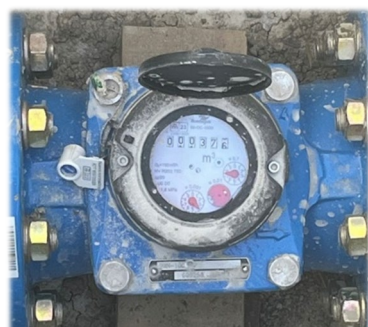
Contador usado durante la recarga
