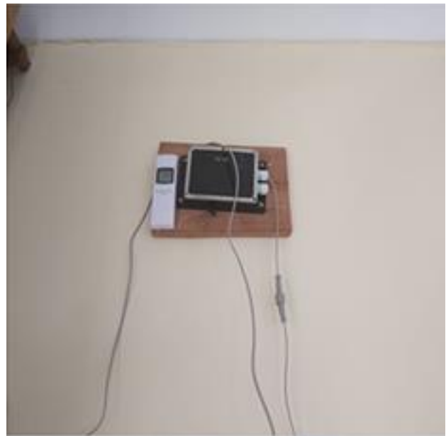
Receiver and indoor sensor installation (d)
