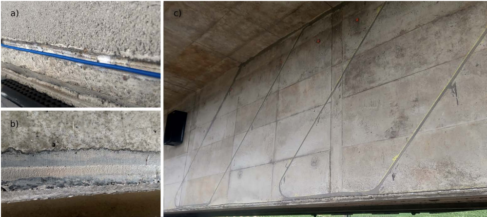
Bild 3: a) Oberflächennahe Verlegung der Sensorfaser in einer Nut, b) Installation der Messfaser nach der Verklebung, c) Ansicht der schleifenförmigen Sensorverlegung während der Installation
