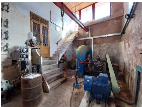
Il·lustració 13: Mini-central hidroelèctrica
