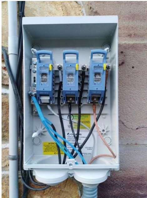
Figura 44. Caja general de protección
