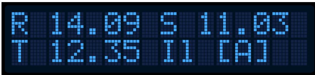
Figura 38. Display la corriente de línea.
