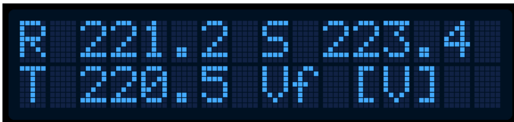
Figura 35. Display del voltaje de fase.
