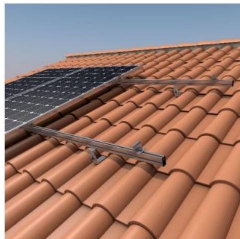
Il·lustració 26: Estructura mòduls fotovoltaics. Font: SUNFER
