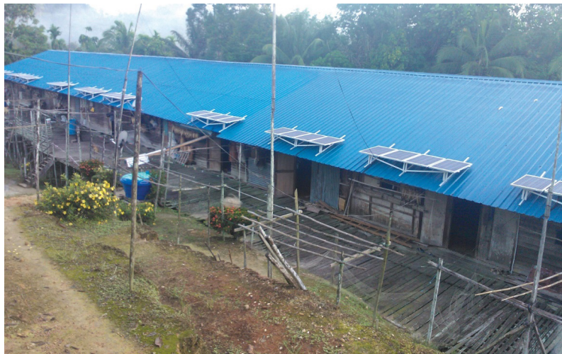
Projek SARES membekalkan tenaga elektrik ke rumah panjang melalui penggunaan tenaga solar.
