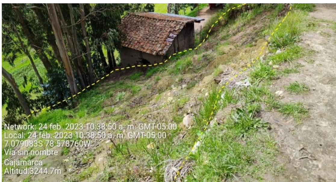
Fotografía 3. Afectación a una vivienda del caserío Chaupimayo y a la calzada de una trocha carrozable local ubicados en la zona de deslizamiento rotacional.
