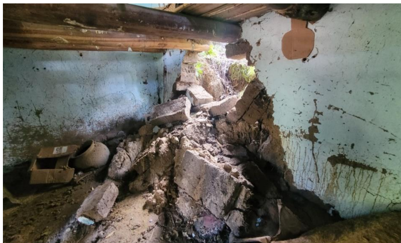
Fotografía 4. Pared colapsada de la vivienda inhabitable, producto del impacto del deslizamiento en el caserío Chaupimayo. Ubicación: E: 767464; N: 9216794; Z: 3220.
