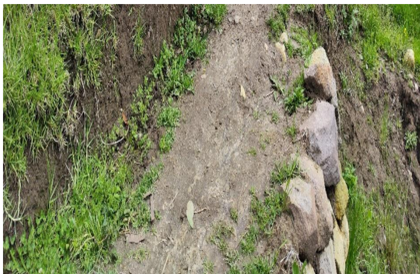
Fotografía 5. Calzada intransitable de la trocha carrozable local, afectada por el deslizamiento. Ubicación: E: 767458; N: 9216810; Z: 3228.
