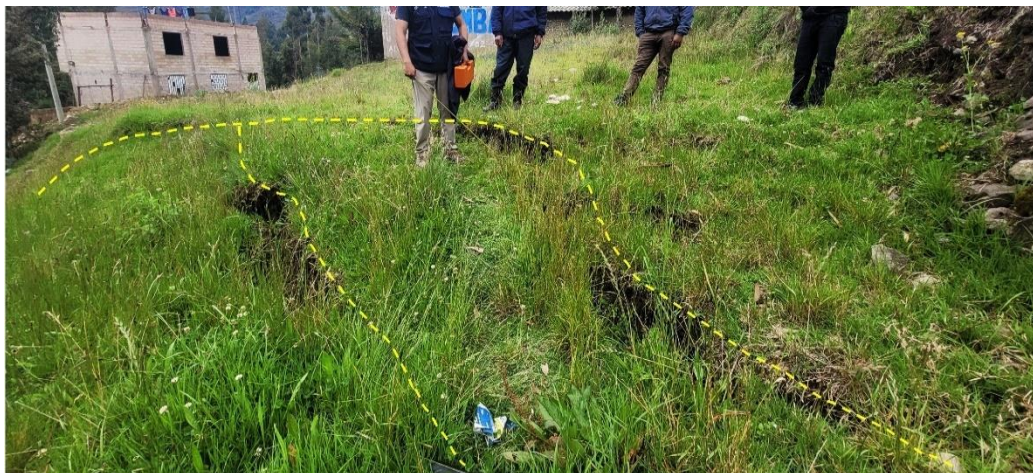
Figura 13. Agrietamientos ubicados detrás de la corona del deslizamiento, que muestran saltos verticales de hasta 50 cm.
