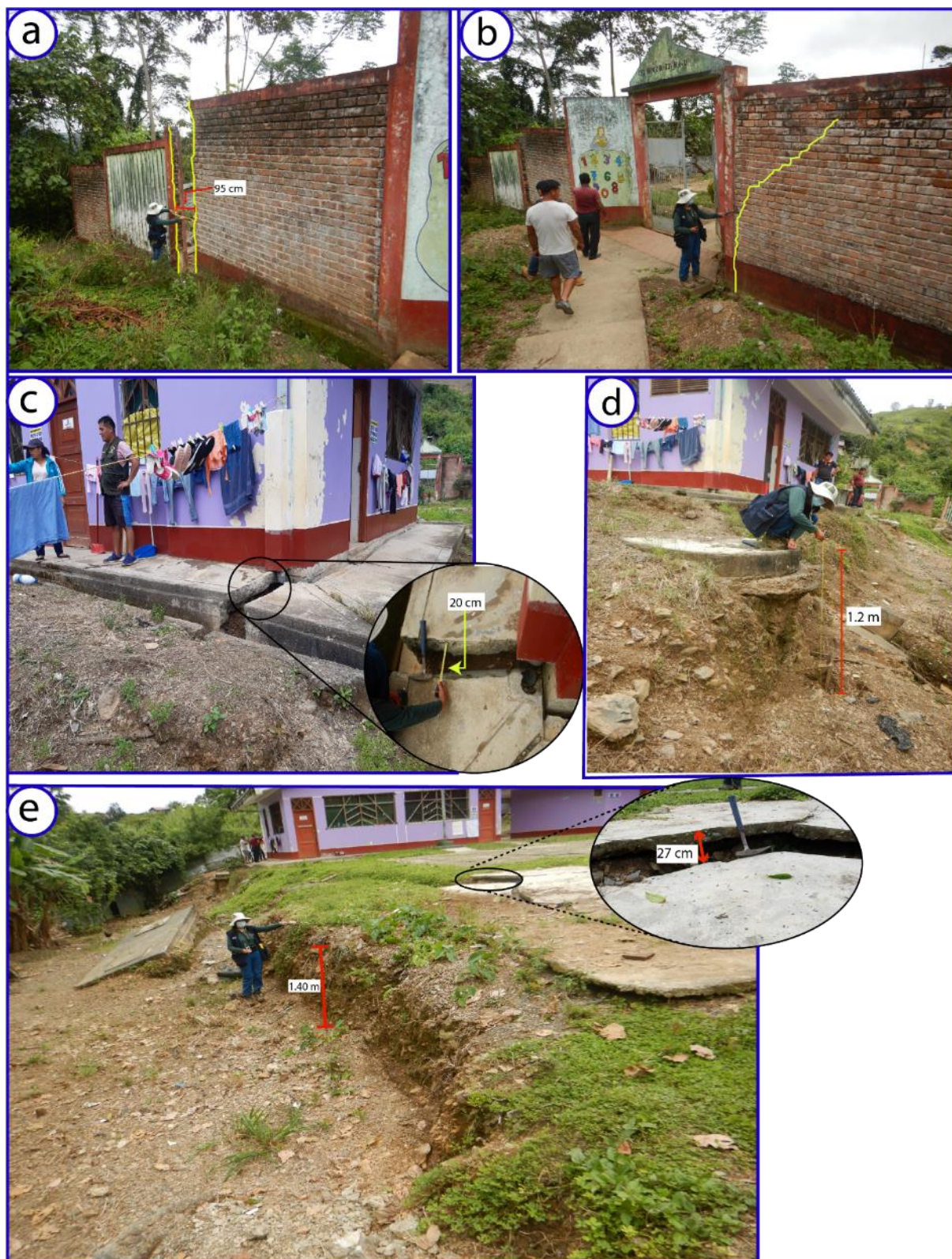
Figura 24. Vista de las afecciones en la infraestructura del Jardín Inicial I.E.I. N°429-73/Mx-U, con coordenadas UTM (WGS 84): 607058 E; 8630315 N. el cual alberga 60 alumnos, a) y b) presenta grietas de hasta 95 cm de abertura en el muro con una longitud de hasta 2.5 m, c) grietas en la vereda con abertura de 20 cm, d) vista de un buzón de agua colgado, con un salto de 1.2 m, e) Vista de un escarpe, con salto de 1.40 m y se observa asentamiento en el patio del jardín con un salto de 27 cm.
