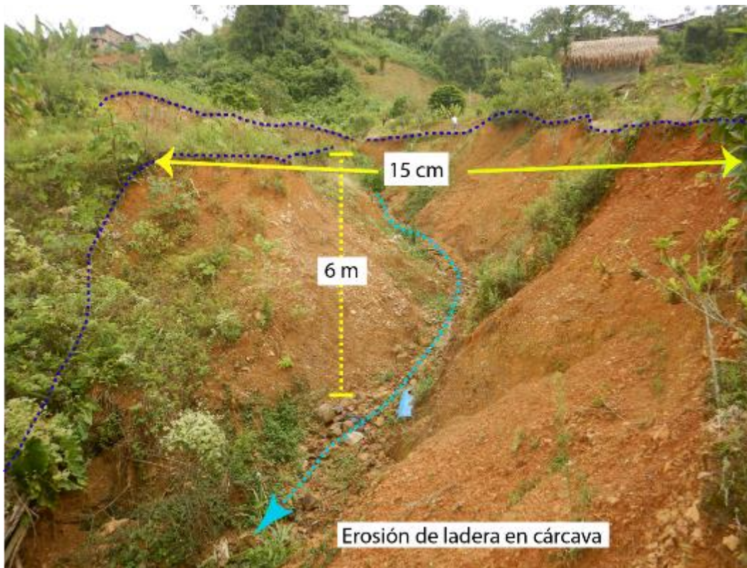
Figura 25. Vista de erosión en cárcava que se desarrollan sobre depósito coluvio-deluvial conformado por fragmentos de rocas con diámetros de 0.5 a 35 cm inmersas en una matriz limoarcillosa. Con coordenadas UTM (WGS 84): 607419 E; 8630519 N, se ubica una cárcava con profundidad de 6 m y un ancho de erosión de 15 m.
