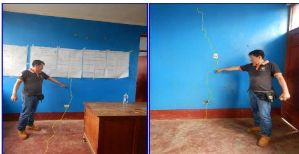
Figura 23. Vista de las grietas en las paredes de la Municipalidad del centro poblado Junín Libertad, ubicado con coordenadas UTM (WGS 84): 607151 E; 8630417 N.
