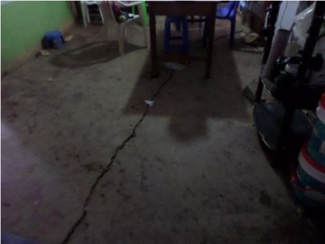
Fotografía 8. Vista de grietas transversales en el piso de una vivienda ubicada con coordenadas UTM (WGS 84): 607248 E; 8630499 N.
