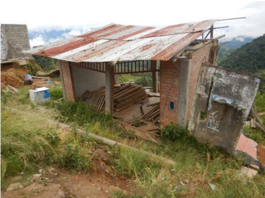
Fotografía 7. Se observa vestigios de las viviendas colapsadas por la ocurrencia del deslizamiento rotacional del 11 de enero del año 2021, ubicada con coordenadas UTM (WGS 84): 607228 E; 8630471 N.
