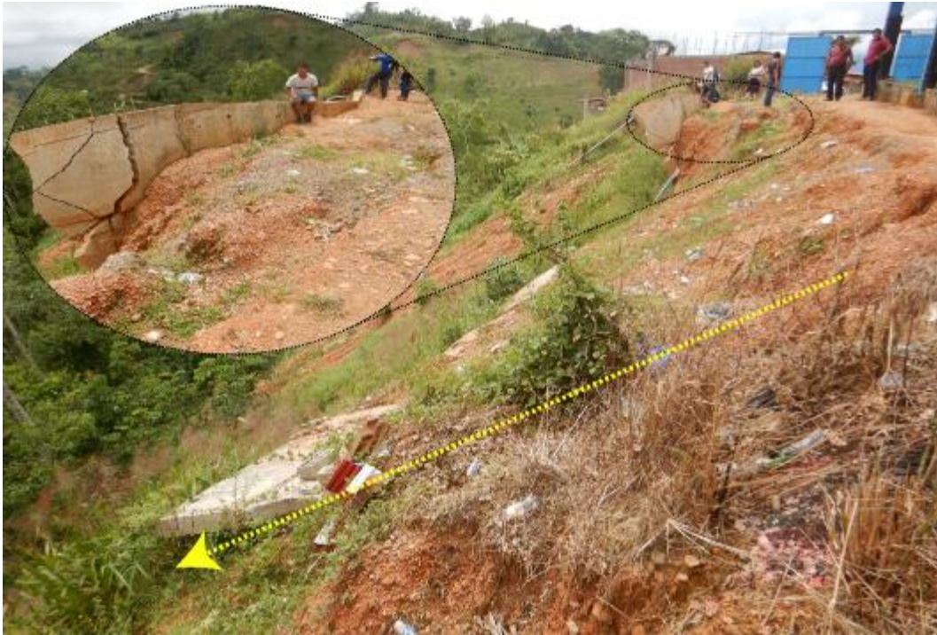
Figura 19. Se observa el colapso de 22 m de los 30 m del muro de contención, el cual se ubica a metros del campo deportivo “Recreo Campestre La Curva” con coordenadas UTM (WGS 84): 607139 E; 8630758 N; cabe mencionar que el campo deportivo mencionado se encuentra asentado sobre material de relleno.
