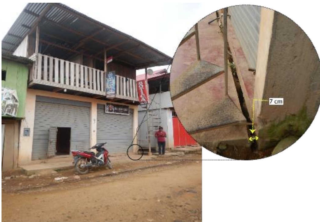
Figura 20. Se observa grietas en la vereda de la vivienda ubicada con coordenadas UTM (WGS 84): 607225 E; 8630731 N, que presenta aberturas de hasta 7cm, esto indica el estado activo del deslizamiento.
