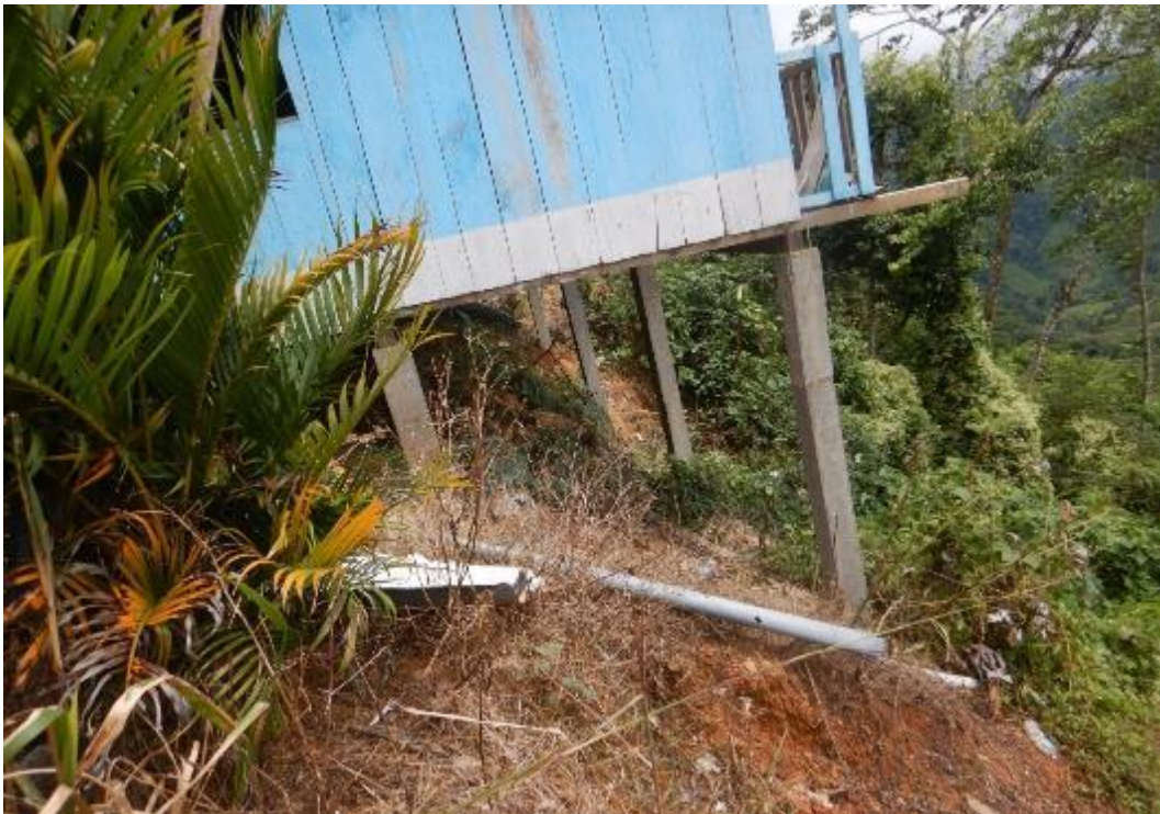
Fotografía 9. Muestra las tuberías de aguas servidas, las cuales desfogán directamente al talud provocando sobresaturación en el terreno, lo cual conlleva a un movimiento en masa ladera abajo.
