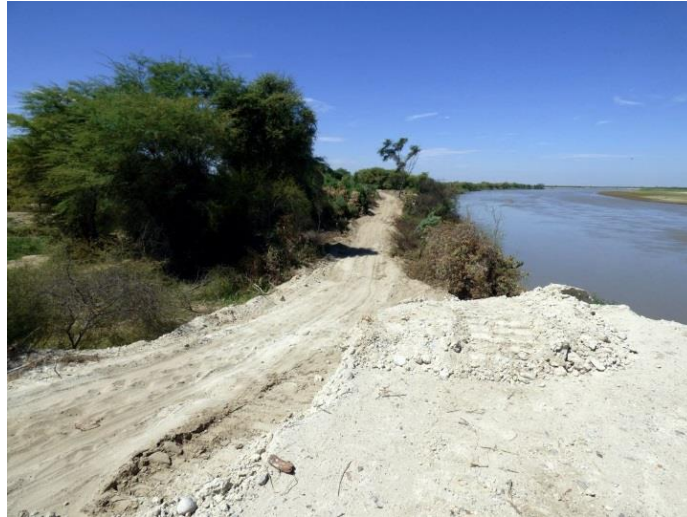
Foto 30: Muro de encauzamiento de tierra de la margen izquierda del río Piura en el sector Los Mores, destruido en una longitud de 140 m.
