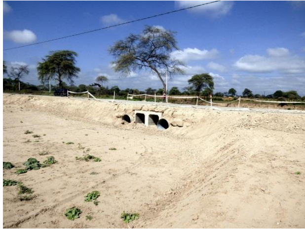
Foto 21: Carretera Piura-Cruce km 50-Olmos; a la altura del caserío Cruz Blanca fue destruida por los flujos de agua y lodo que discurrieron por una torrentera de corto recorrido y baja pendiente.
