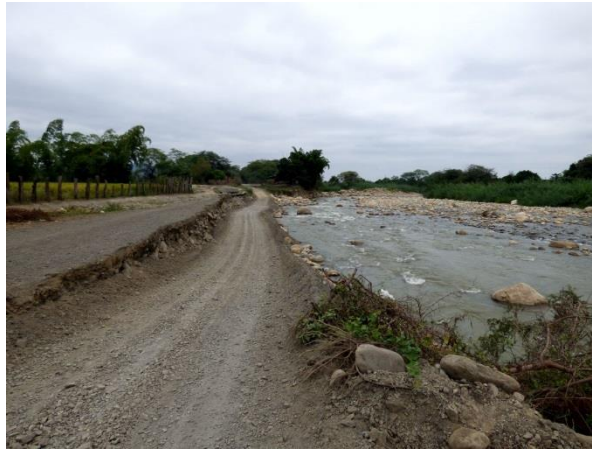
Foto 27: Tramo de 220 m carretera erosionados por el río San Jorge en la ruta de acceso a la localidad San Pedro.
