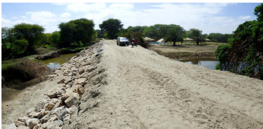
Foto 32: Muro de encauzamiento en la margen izquierda del río Piura, destruidos en el sector El Rancho, produjo el desborde e inundación de Catacaos, Simbilá, etc.
