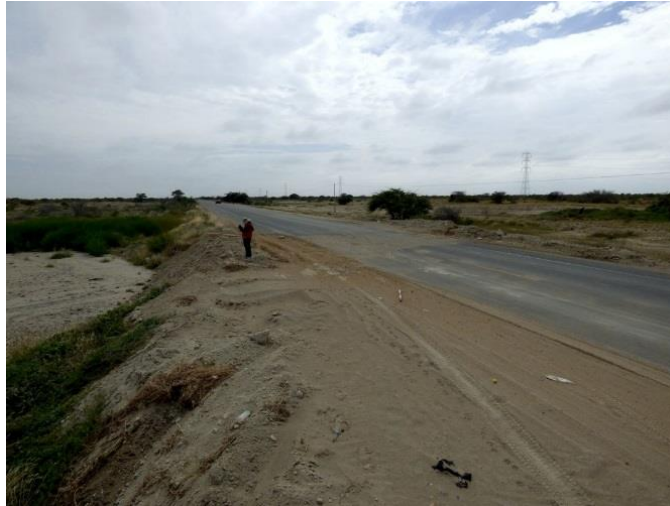
Foto 24: Panamericana Norte erosionada a la altura del km 915+840 por los flujos de agua que discurrieron por quebrada que permanece seca por largos periodos de tiempo.
