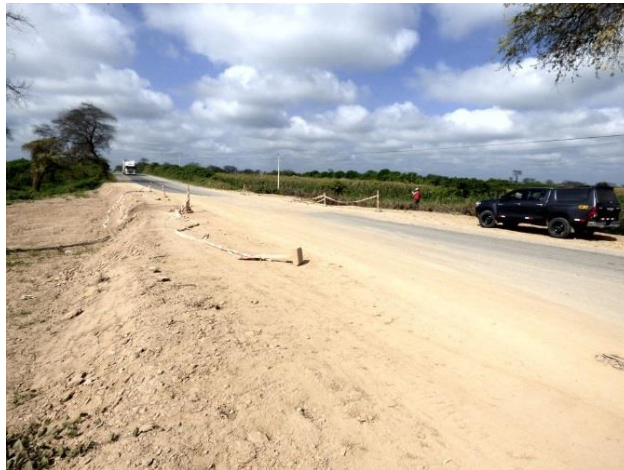
Foto 22: Carretera Piura-Cruce km 50-Olmos, a la altura del km 195+000 destruidos por flujos de lodo y agua discurridos por quebrada seca, que se activa excepcionalmente.
