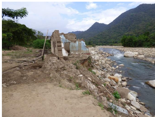
Fotos 16 y 17: Vista de las viviendas y terrenos de cultivo destruidos en la margen derecha del río Piscán, en el sector Mambluque, del distrito Yamango.
