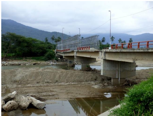
Foto 37: Puente Salitral afectada por la erosión producida por el río Piura, la loza del puente se asentó y fue necesario colocar un puente tipo Bailey para habilitar el tránsito hacia la localidad de Salitral.
