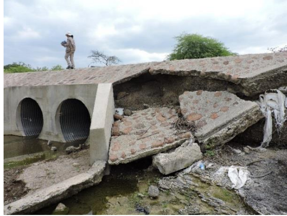
Foto 3: Quebrada Peña Blanca, en este punto se observa un puente con dos alcantarillas, los cuales soportaron la gran cantidad de agua que discurrió por esta quebrada; sin embargo, los márgenes de este puente mostraban el colapso que sufrieron sus estructuras, causadas por las aguas que discurrían por las cunetas, las cuales socavaron el piso, en ambos estribos del puente.
