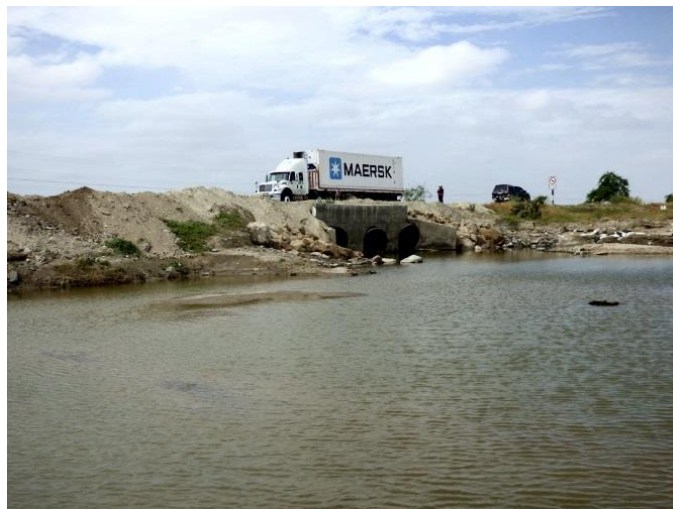
Foto 25: Panamericana Norte erosionada en los bordes de alcantarillas a la altura del km 915+050.
