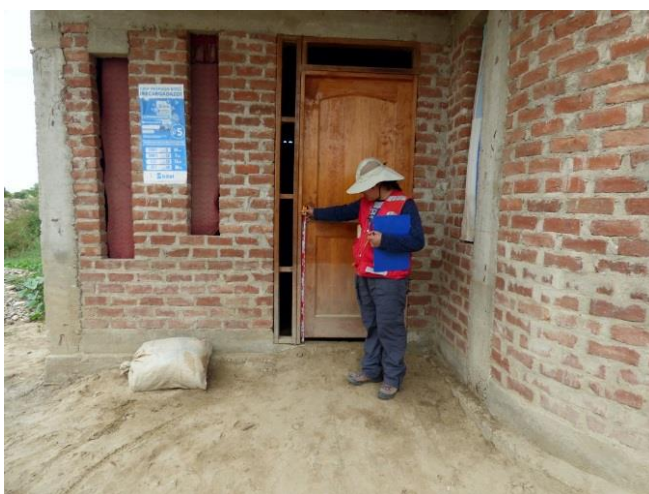
Foto 8: El nivel de la inundación en la zona Pedregal Grande fue de 0,67 m, aquí fueron afectadas las viviendas de material noble y las viviendas de material rustico fueron destruidas.
