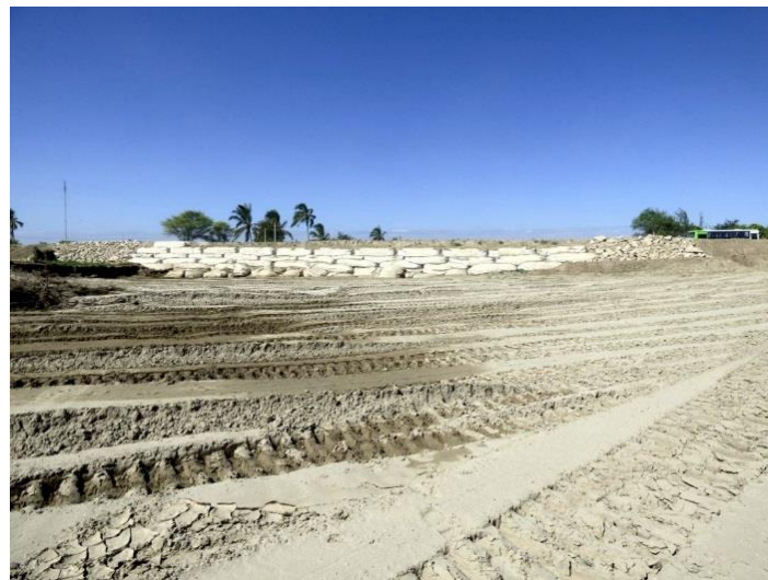
Foto 33 y 34: Muro de encauzamiento en la margen izquierda del río Piura destruido en una longitud de 90 m; causó inundación en Pedregal, Pedregal Grande y Pedregal Chico.
