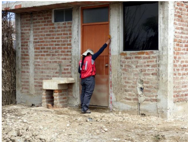
Foto 10: Sector San Martín de Cucungará, donde la inundación alcanzó 1,4 m de altura, fueron afectadas las viviendas de material noble y destruidas las de material rústico.
