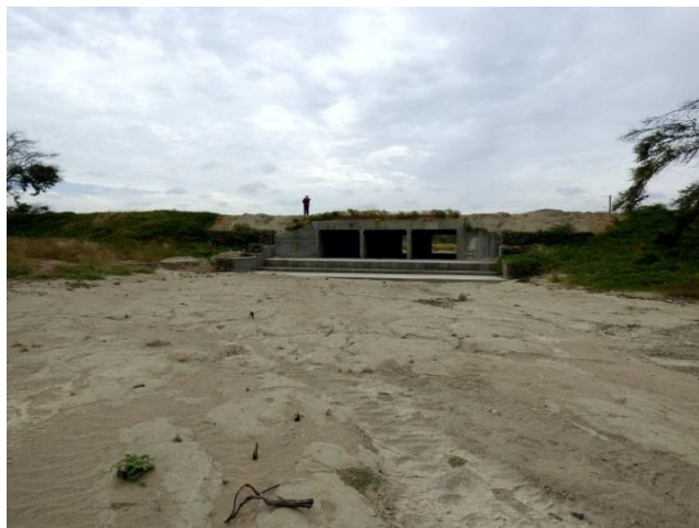
Foto 23: Panamericana Norte erosionada a la altura del km 944+135 por los flujos de agua que discurrieron por quebrada seca.
