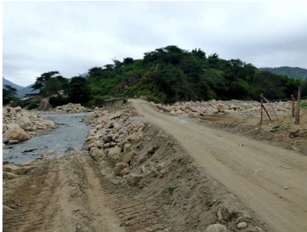
Foto 36: Estribos de puente inclinados por la erosión producida por el río Chalaco en su margen izquierda, también destruyó terrenos de cultivo.
