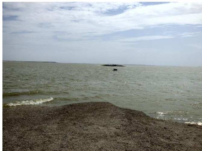
Foto 26: Carretera a Bayóvar destruida totalmente en una longitud de 216 m por las aguas que se acumularon por la formación de la Laguna La Niña.
