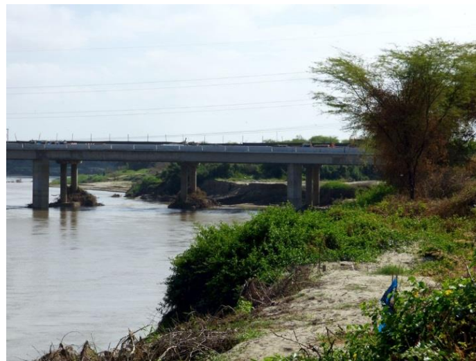
Foto 31: Margen izquierda aguas arriba del puente Grau, afectada por erosión fluvial que puede afectar estribo del puente.
