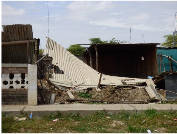
Foto 12: Vivienda destruida en el sector Pozo de Los Ramos por las aguas desbordadas del río Piura.
