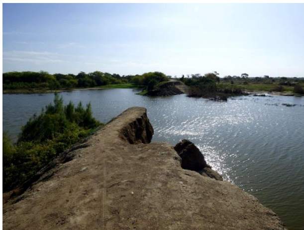
Foto 29: Muro de encauzamiento de tierra del río Piura de la margen izquierda roto en una longitud de 108 m, causó inundaciones de poblaciones y terrenos de cultivo.
