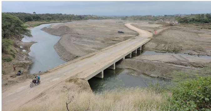
Foto 4: En la foto se puede observar que el puente quedó como una isla en todo el ancho del cauce, aquí las aguas discurrieron por todo el ancho de la quebrada, según información, el agua inclusive llegó a sobrepasar el nivel del puente y los flujos de detritos taparon por completo los canales del puente, permitiendo que el agua se desborde por la parte lateral más plana.
