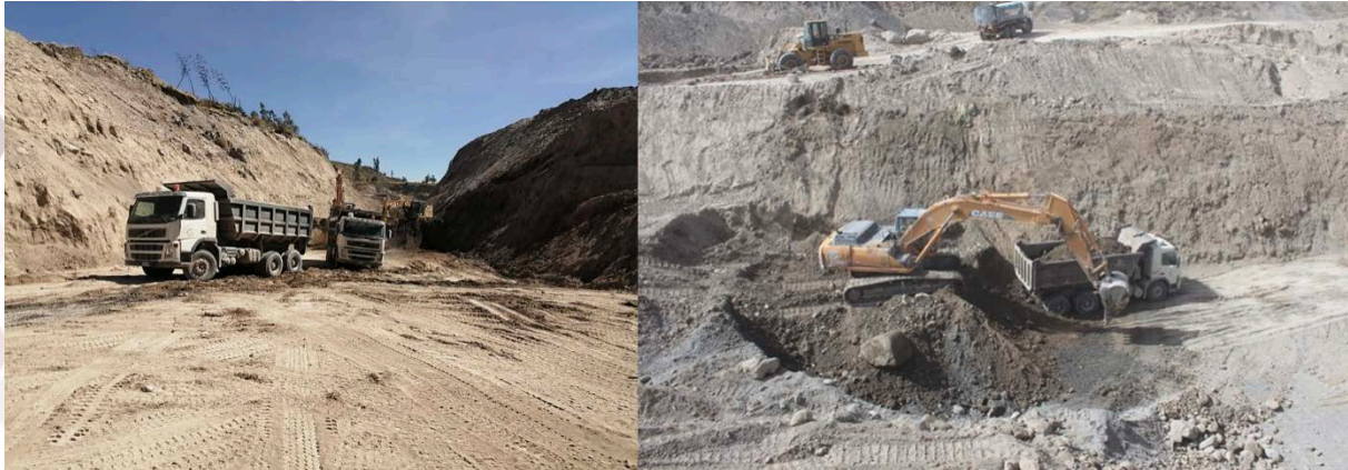
Figura 5. Trabajos de remoción de tierras para la construcción del canal de desagüe y efectuar el des-embalse (Fotos: Autocolca).
