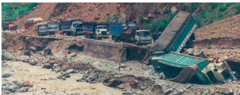
Figura A22.4 Carretera Central del Perú, aguas abajo de la quebrada Viso, totalmente erosionada por el paso del flujo de detritos (Huayco) (Fotografía El Comercio, enero 1998).
