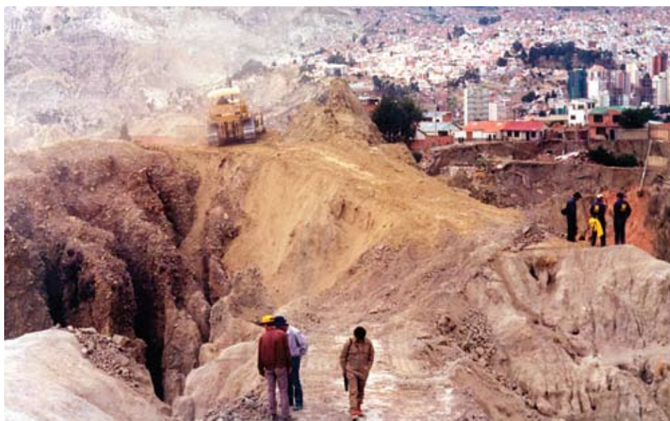
Figura A.5.6 Inicio de los trabajos de rehabilitación del deslizamiento de San Isidro en base a movimiento de grandes volúmenes de tierra, para generar una cuña resistente al pie del deslizamiento.
