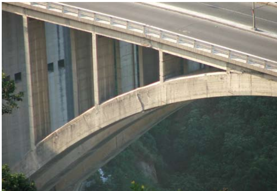
Figura A.4.8 Rotura del arco Este como consecuencia del evento del 5 de enero de 2006.
