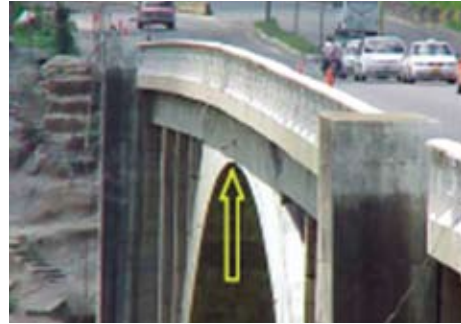
Figura A.4.7 Ascenso de la clave del arco debido al cierre de su cuerda por el empuje del deslizamiento. El ascenso para noviembre 2005, era de 80 cm.
