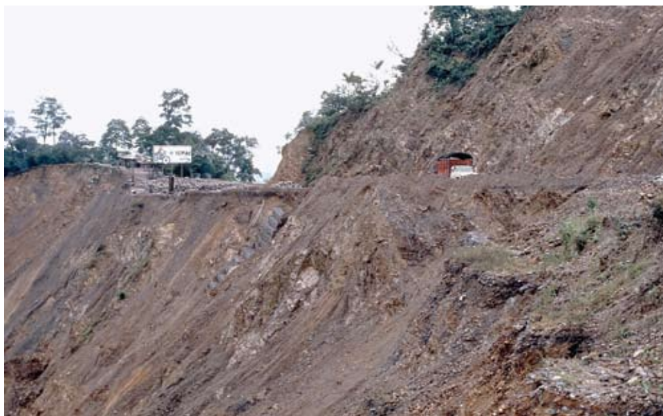
Figura A.15.3 Se observan los efectos de la erosión remontante que comienza a afectar la carretera en 1970.
