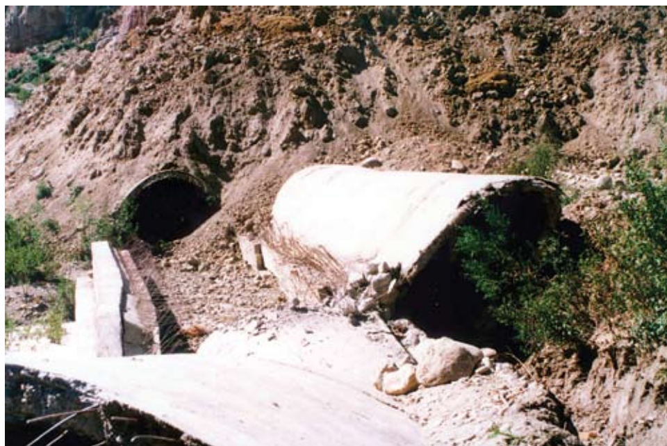
Figura A.75 Detalle de la destrucción de los cañones del embovedado del río Orkojahuirá que fueron levantados y rotados.
