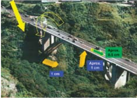
Figura A.4.6 Relación entre los desplazamientos en la estructura, debido al empuje del macrodeslizamiento.
