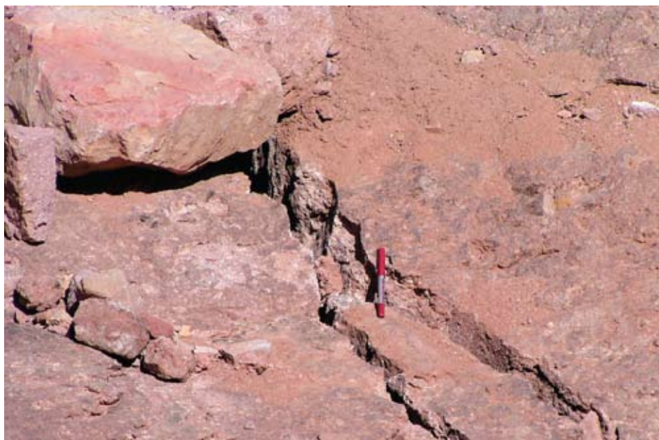
Figura A.3.2 Fractura producida por el impacto del bloque caído sobre otro ubicado a media ladera.
