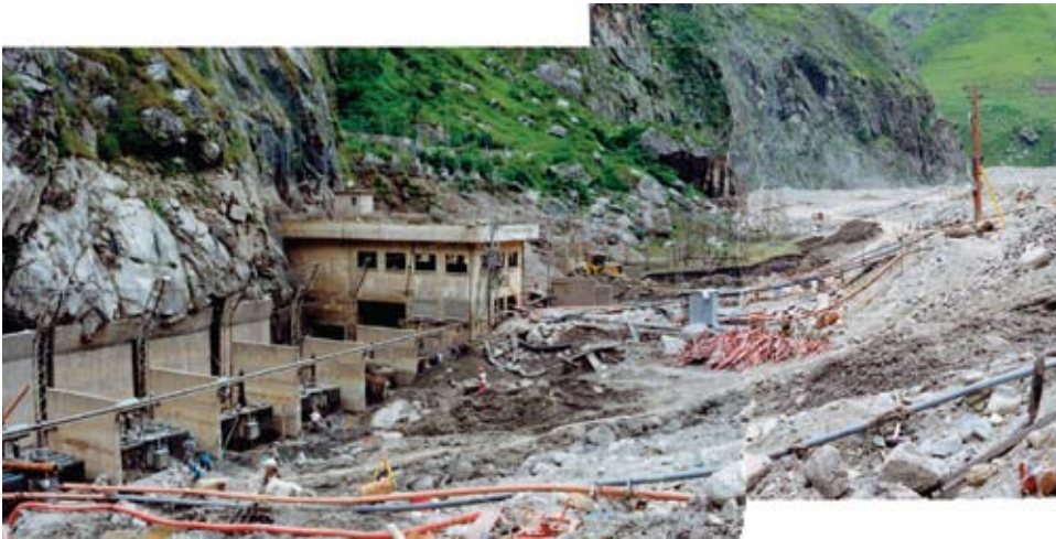
Figura A.25.4 Vista del edificio de Control de la Central Hidroeléctrica de Machu Picchu en donde se observa la intensidad de los daños. Por las ventanas ingreso el agua y lodo que daño la casa de máquinas (subterránea).
