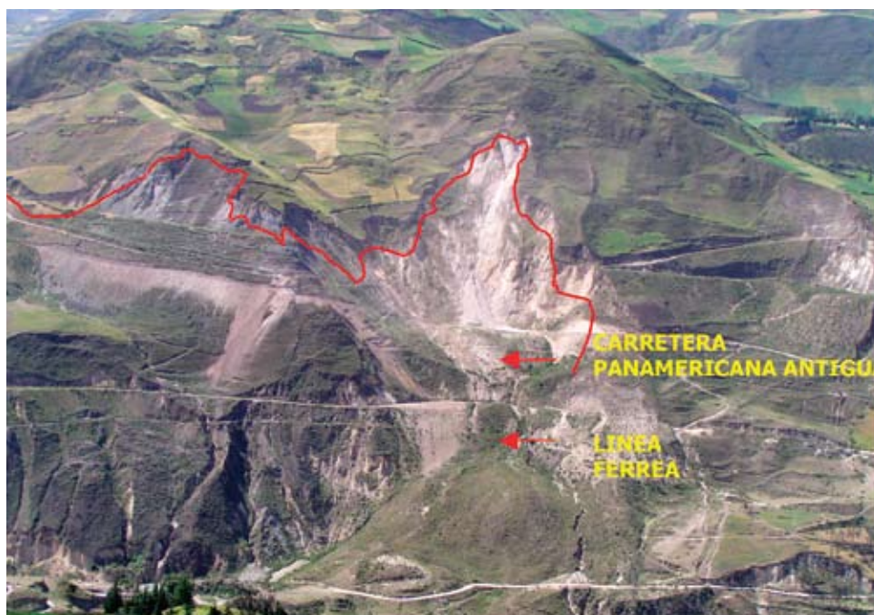
Figura A.27.2 Zona de desprendimiento del material en la Loma Llallarón, Las Moras, que causó la destrucción de un tramo de la carretera y del ferrocarril (Fotografía DINAGE).
