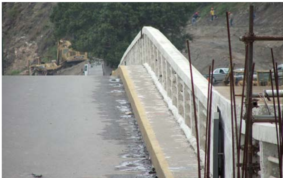
Figura A.4.9 Vista de la deformación vertical del tablero en la sección fracturada el 5 de enero 2006. Para la fecha de la foto, la deformación vertical de dicha sección era de 167 cm. Fotografía tomada el 9 de marzo de 2006, 10 días antes del colapso del Viaducto.
