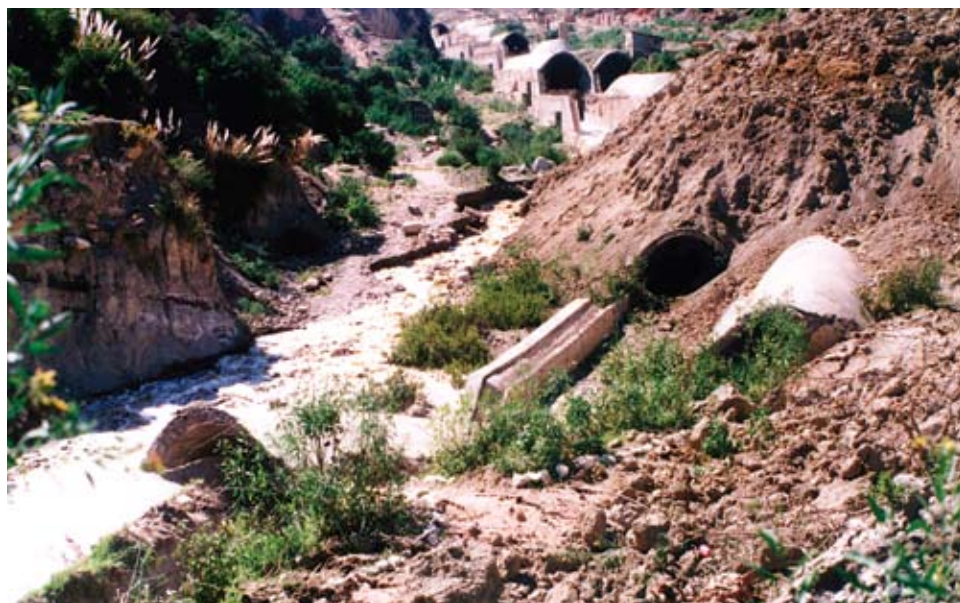
Figura A.7.4 Vista lateral del material deslizado y la destrucción de los dos cañones del embovedado del río Orkojahuirra que se encontraba en construcción. También se observa la acumulación de material característica de un deslizamiento rotacional.
