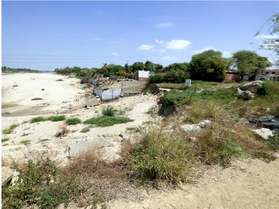
Foto 8: Erosión fluvial en la margen derecha del río Piura, aguas abajo de la presa Los Ejidos, afecto parte de la estructura de las viviendas asentadas en el borde del río.
