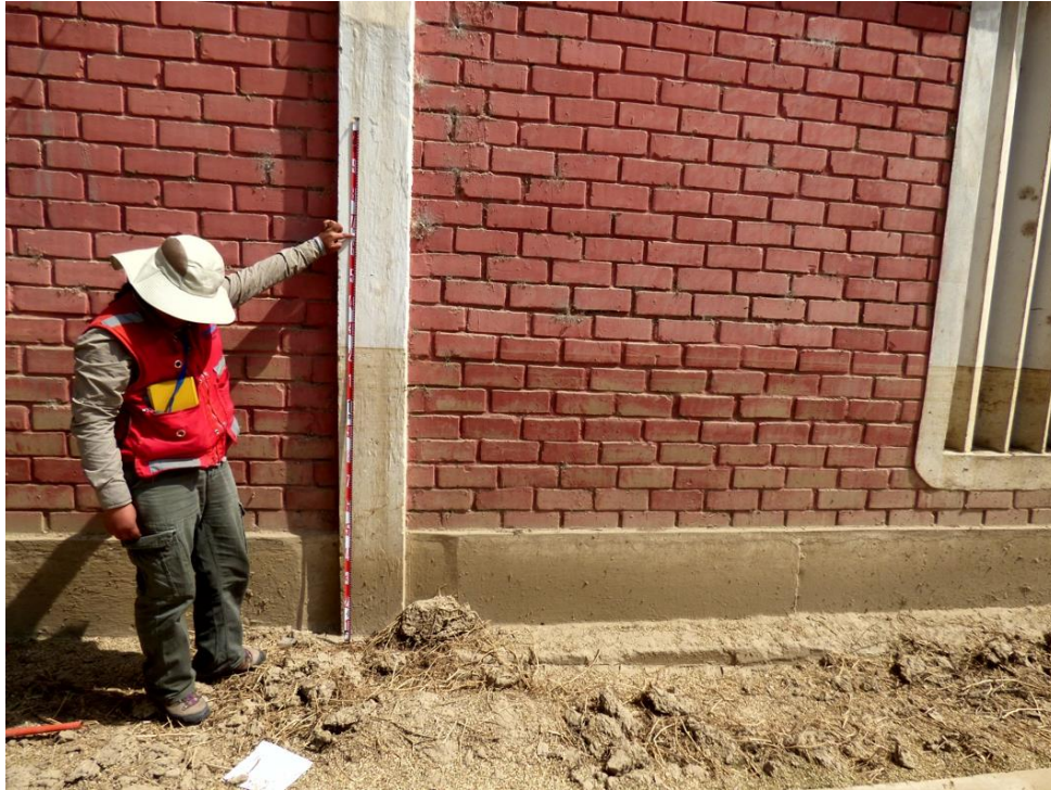
Foto 10: Los niveles del agua desbordada alcanzados dentro de la Universidad de Piura fue de 1,2 m de altura, que dañaron severamente la infraestructura de la institución.
