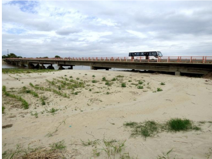
Foto 20: Colmatación con material fino en el estribo izquierdo del puente Independencia.
