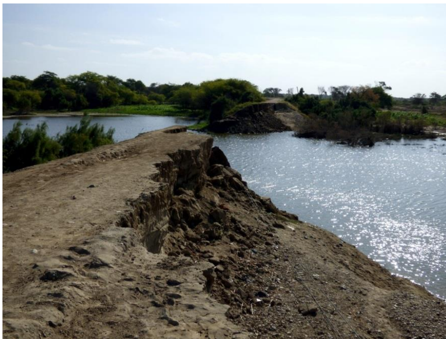
Foto 19: Muro de encauzamiento en la margen izquierda del río Piura, sector Pan de Azúcar, la rotura tuvo una longitud de 108 m, además de provocar la inundación de terrenos de cultivo, también derribó postes de transmisión eléctrica.
