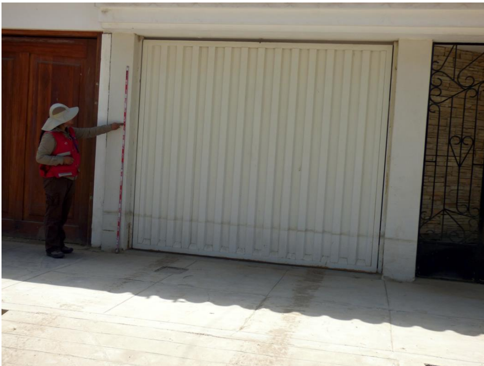
Foto 9: Cerca de la urbanización El Chipe en la margen derecha del río Piura, el nivel de las aguas desbordadas alcanzó una altura de 0,45 m; en la imagen es posible observar la marca dejada en el portón de una vivienda.
