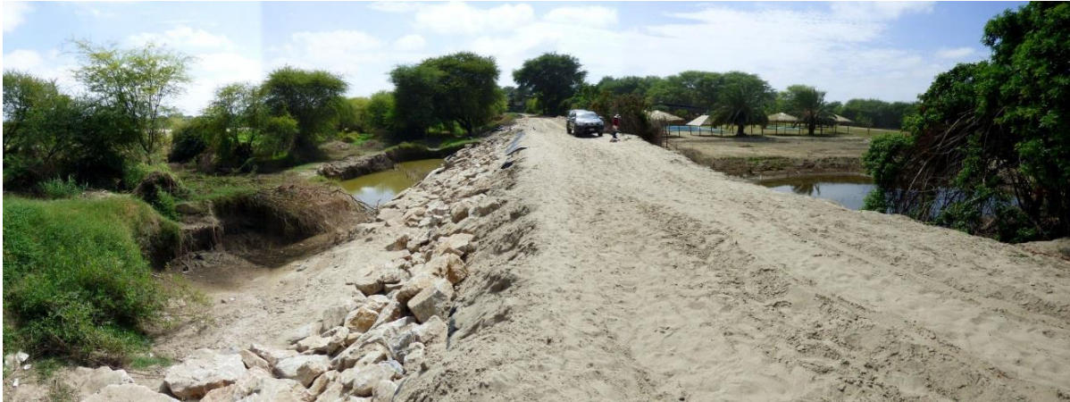
Foto 16: Muro de encauzamiento roto en el Sector El Rancho, que causó las inundaciones en Catacaos y Simbilá; también es posible observar el material fino que colmata el cauce y la vegetación riverena crecida (lado izquierdo de la foto).
