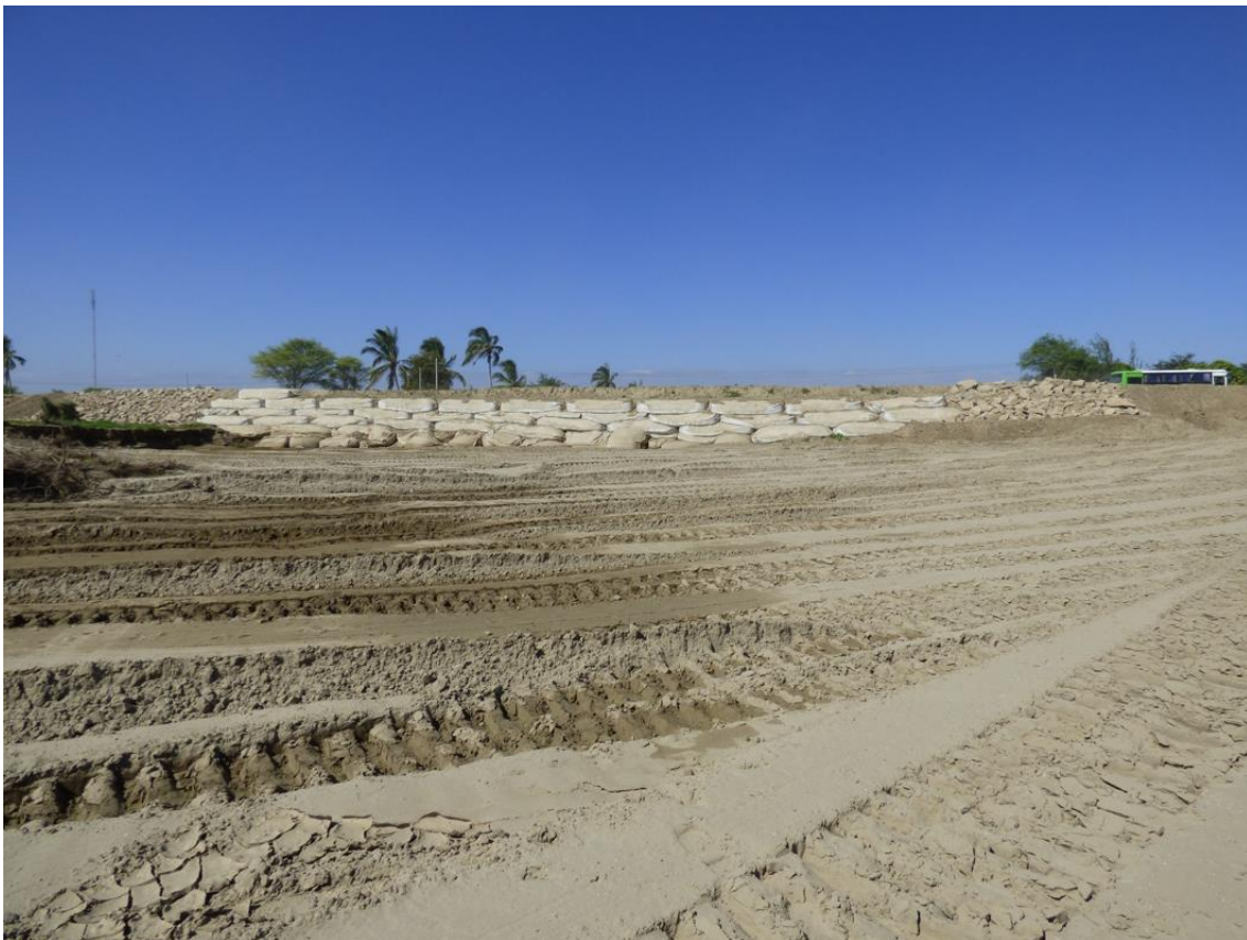
Foto 17: Muro de encauzamiento roto en el sector Pedregal que causó los mayores daños por la inundación generada en las localidades de Pedregal y Cucungará.
