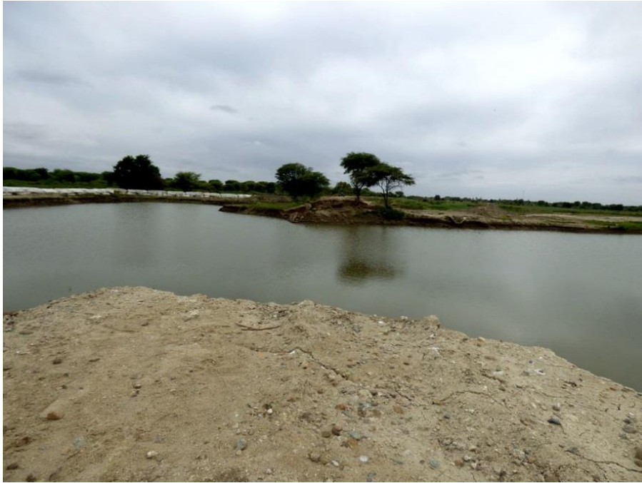
Foto 18: Rotura de muro de encauzamiento ubicado a 500 m aguas abajo del puente Independencia, la zona afectada fue de 65 m.
