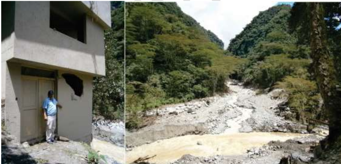
Figura 4.2. Zona crítica 21: Flujo de detritos y derrumbe en la quebrada Toropaccha(San Ramón) en la provincia de Chanchamayo. Deja un orificio dejado por el run-up de 2m (izquierda).
