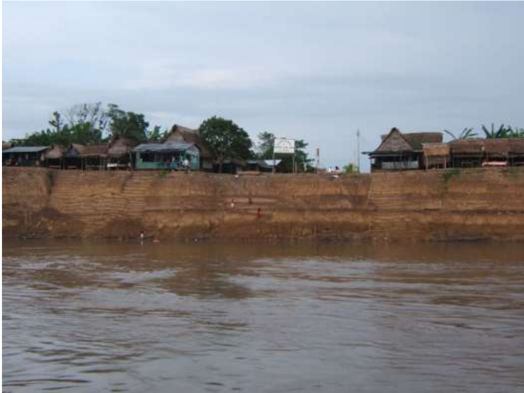
Fotografía 7.2. Zona crítica 19: Erosión fluvial en Nuevo San Juan - Juan Velasco Alvarado (Manantay) en la provincia Coronel Portillo.
