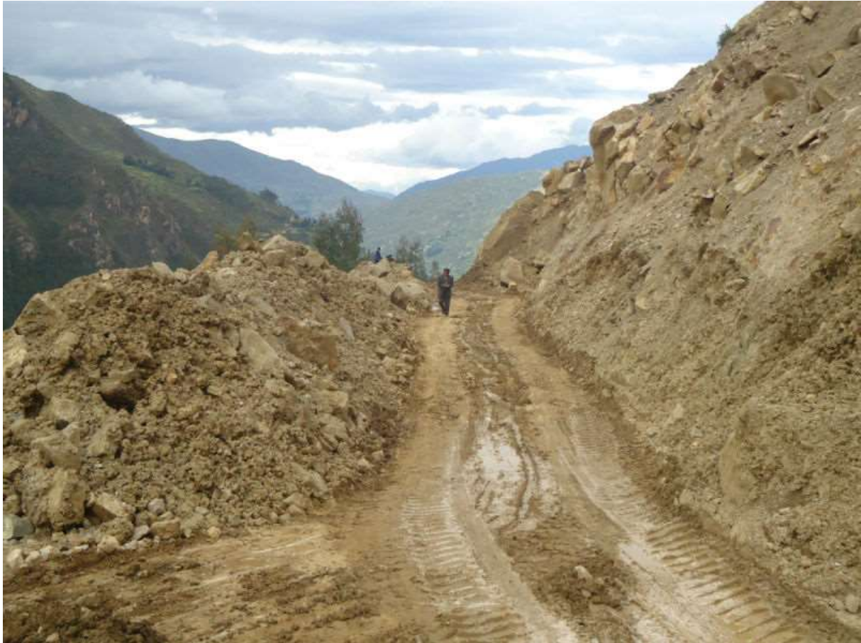
Fotografía 6.2. Zona crítica 6: Derrumbe, erosión de laderas en Santa Ana de Tusi , Pampania (Santa Ana de Tusi) en la provincia Daniel Alcides Carrión. En febrero del 2012, interrumpió el tránsito de la carretera, específicamente en el tramo hacia el ingreso del Centro Poblado de Pampania. (Tomado de: http://diariocorreo.pe ).
