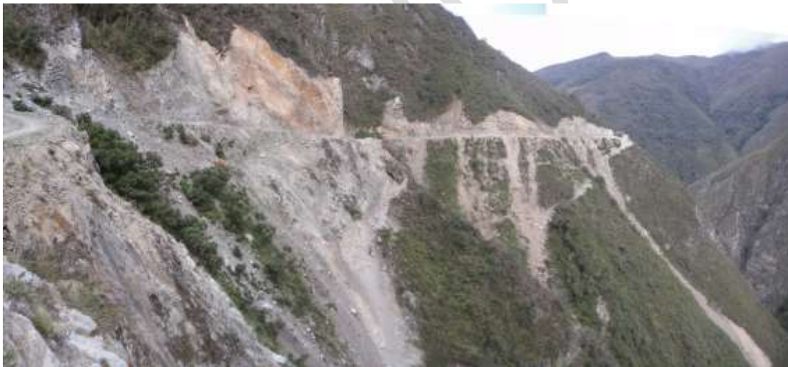
Fotografía 4.1. Zona crítica 9: Derrumbes en la Carretera Anturqui – Huanchuro (San Pedro de Cajas), en la provincia de Tarma. Afectan a la carretera que está siendo afirmada. Los últimos derrumbes ocasionaron la volcadura de maquinaria.
