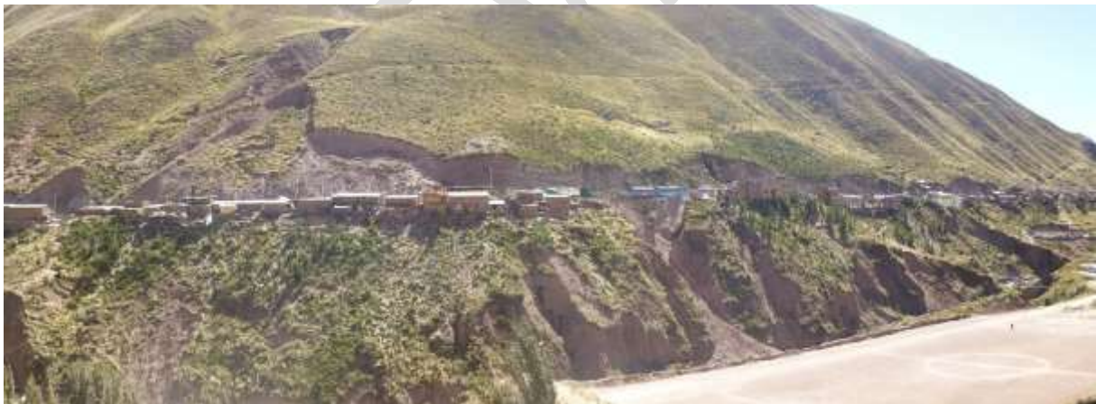
Fotografía 5.8 Zona crítica 61: Erosión de ladera, derrumbe y Deslizamiento en el sector Casapalca afecta un tramo de la carretera Central, en el Km. 117+000
