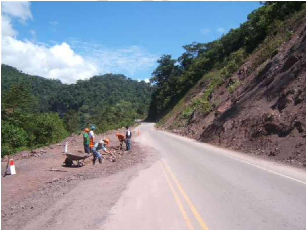
Fotografía 7.3. Zona crítica 11: Caída de rocas, derrumbe y deslizamiento en caserío Nuevo Mundo (Boquerón) en la provincia Padre Abad. Afecta la carretera Federico Basadre
