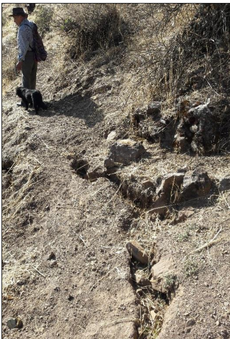
Foto 3: grietas tensionales en el sector 1.
