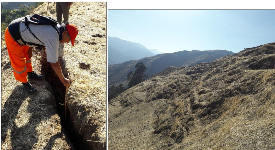
Foto 7: izquierda, grieta tensional muy profunda en el sector 2. Foto 8: derecha, ladera norte de la loma Pirca, con pequeños saltos y desniveles que hacen suponer la existencia de deslizamientos superficiales antiguos.
