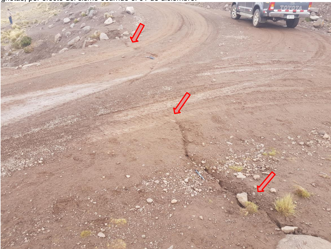
Foto 10. Detalle de la abertura y desnivel producto del asentamiento del dique en la margen izquierda.
