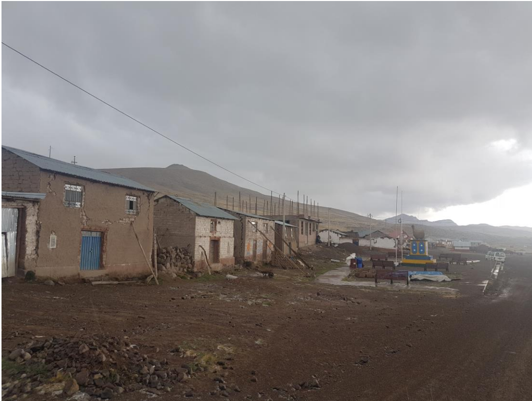
Foto 05: Daños en viviendas, la mayoría de viviendas se encuentran agrietadas. Poblado Parina.
