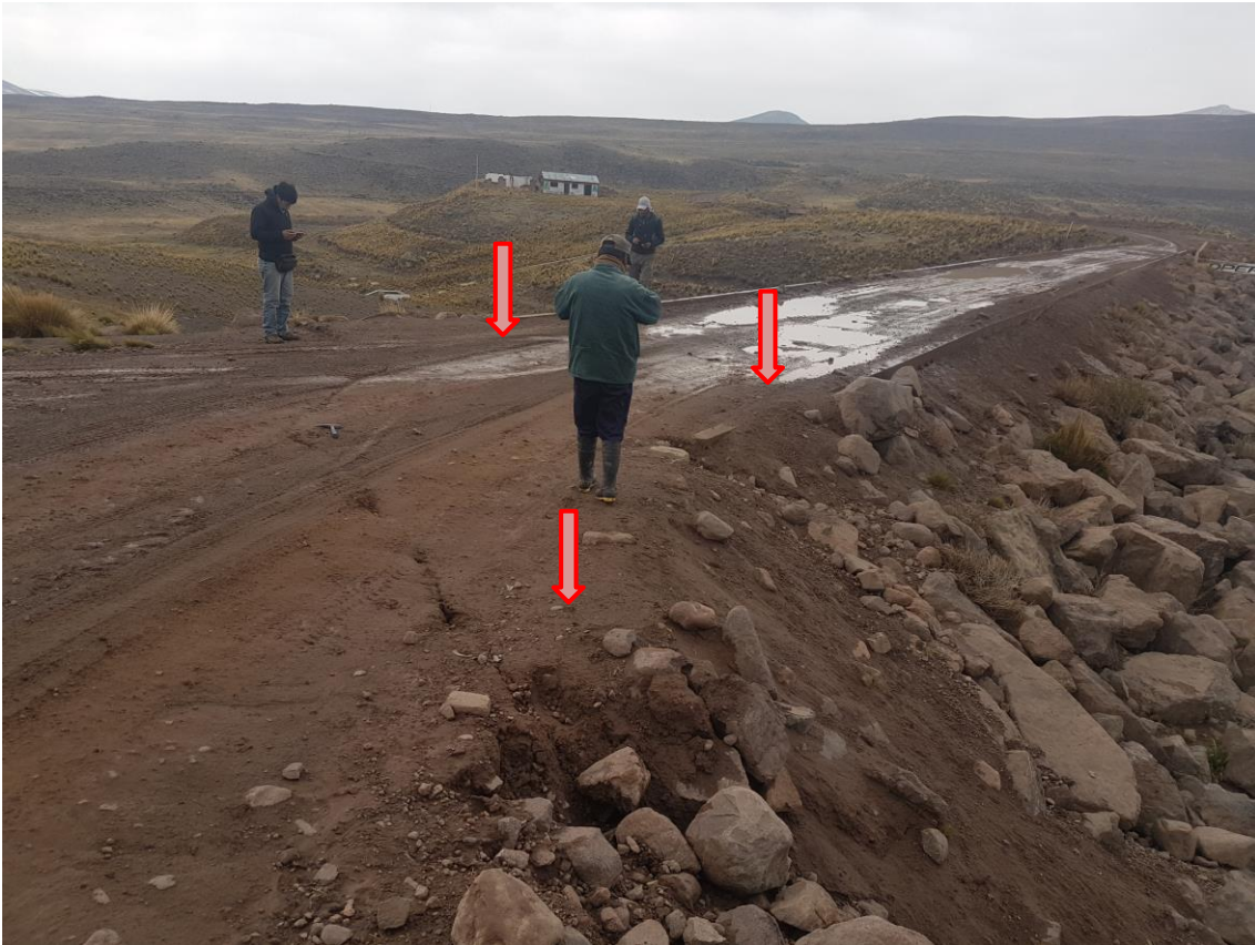
Foto 09. Grieta en la margen izquierda del dique de la represa Saguanani con presencia de grietas, por efecto del sismo ocurrido el 01 de diciembre.
