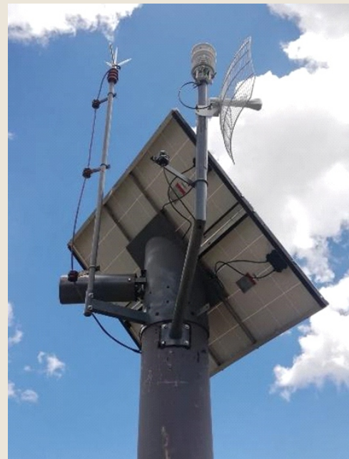
► Fig. 2 - Parte de la estructura metálica de una estación que alberga varios instrumentos con sensores expuestos.
