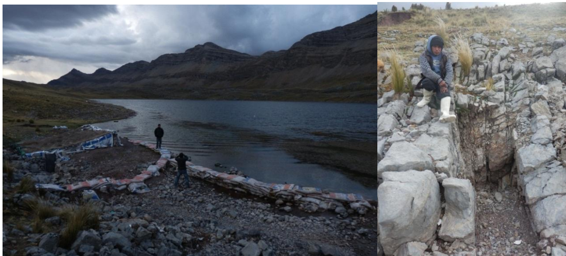
Foto 2. Vista aguas arriba de la laguna Huascacocha. Las unidades geológicas que existen en sus inmediaciones (estratos) muestran una inclinación o buzamiento de (15° a 50°) al noreste. La vista derecha muestra un detalle del grado de fracturamiento en las calizas fracturadas y alteración en las rocas de la Formación Chaucha
