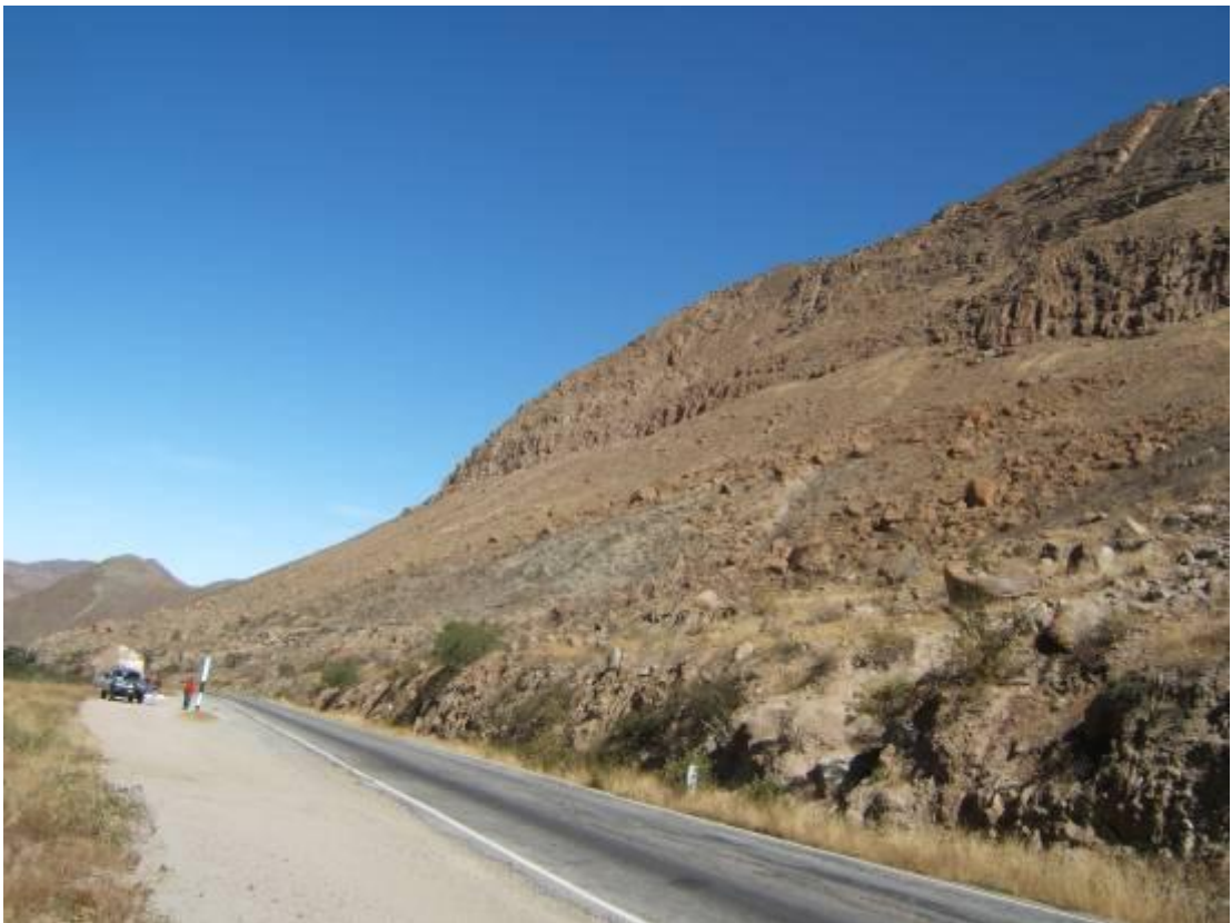
Foto 33 Área susceptible a caída de rocas en el sector del cerro Huana Cayán, Km 70-71 Pativilca-Conoccocha.
