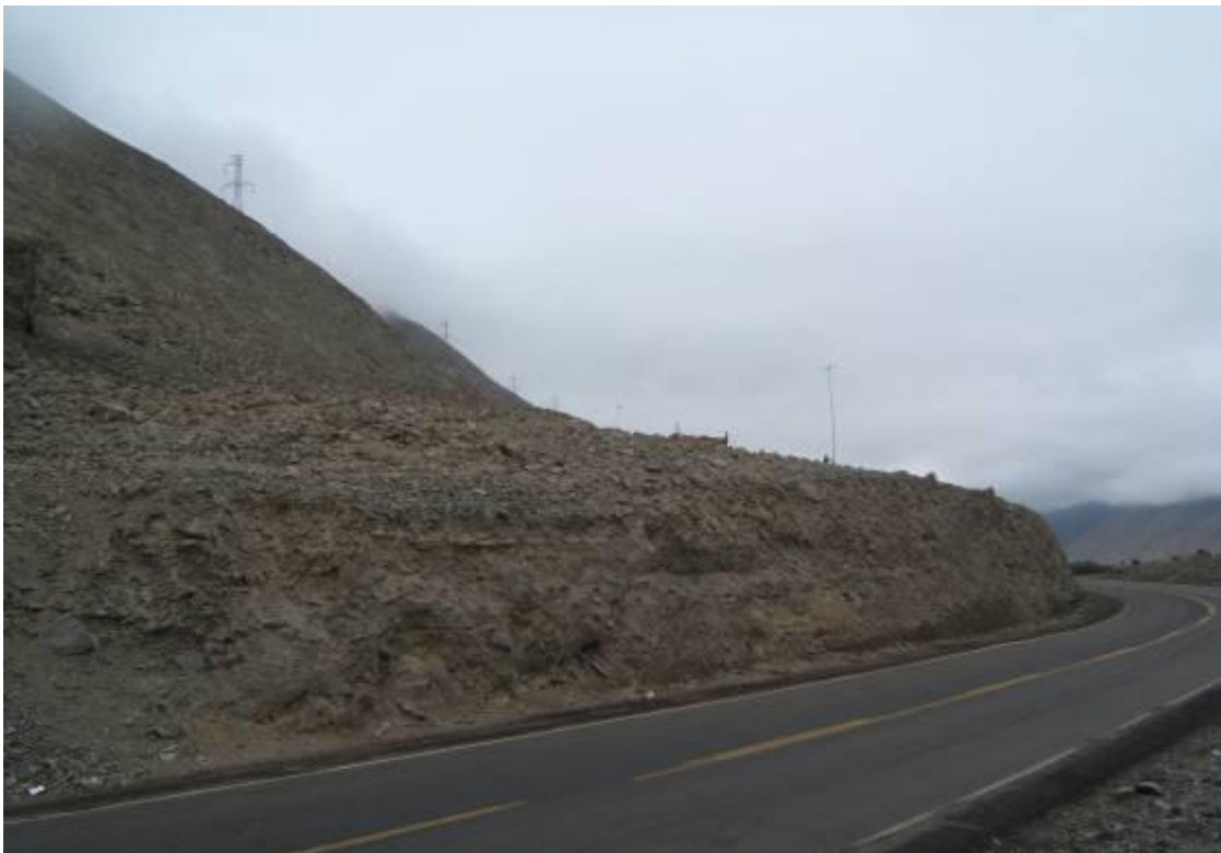
Foto 13 Talud de corte de carretera sobre depósitos coluvio-deluviales, sector Cutatambo; muestra acumulación de bloques angulosos no canalizados caídos por gravedad con arrastre pluvial.
