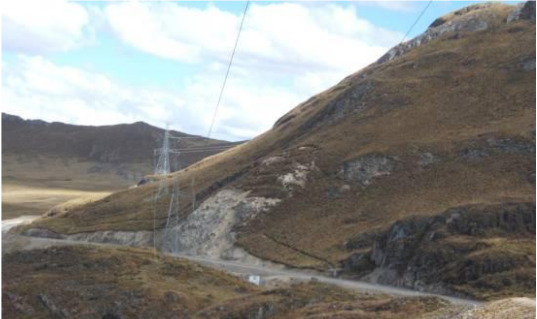
Foto 53 Deslizamiento traslacional en el sector cerca de laguna Vinchos (Km 110+720 al 110+800, tramo Conococha-Antamina).
