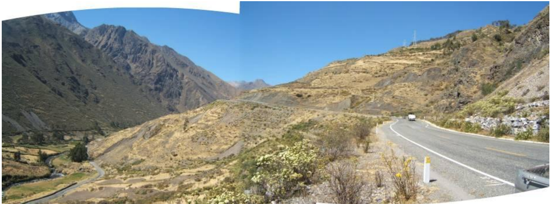
Foto 65 Deslizamiento de Uranyacu, zona crítica por reactivación de deslizamiento en talud inferior.
