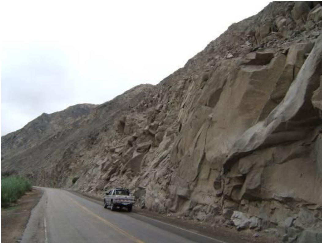
Foto 31 Taludes de corte y laderas susceptibles a caída de rocas, sector de la quebrada Maray Colca (Km 41 Pativilca-Conococha).
