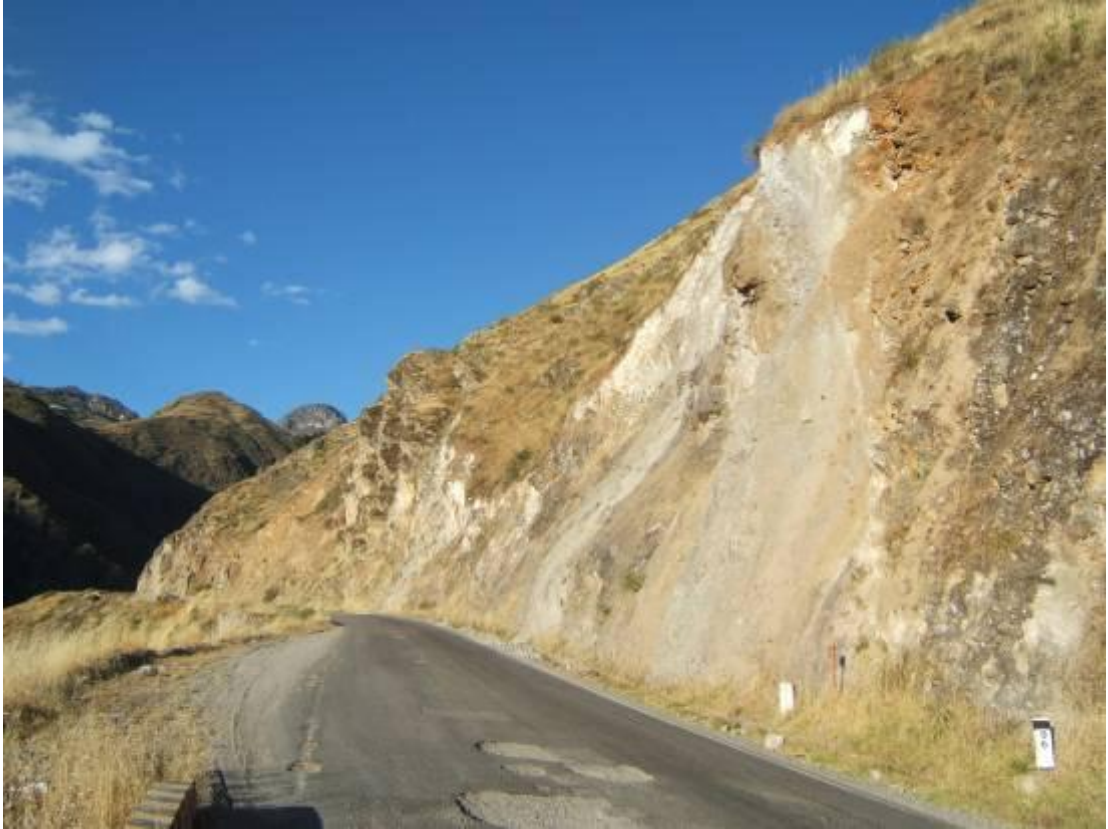
Foto 34 Tramo de carretera (Km 95+600 al 96+250, Pativilca.-Conococha), afectado por derrumbes.
