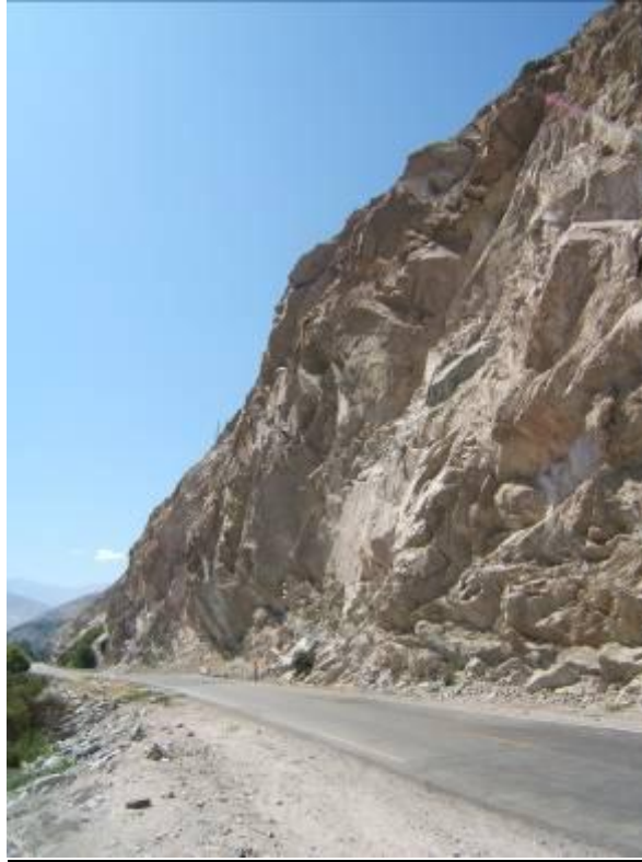
Foto 36 Tramo de la carretera Pativilca-Concocochoa en rocas intrusivas muy fracturadas, afectada por vuelco, sector cerro Botija (Km 53+850).
