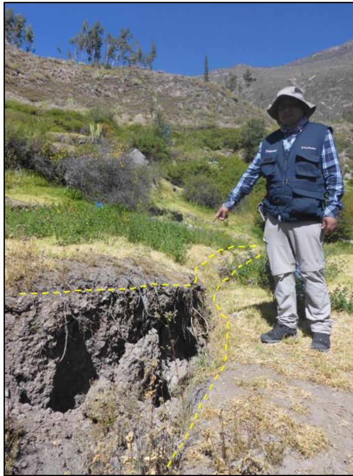
Figura 9. Agrietamientos G1 en terrenos de cultivo en Anascapa, (coordenadas UTM WGS84: 301987E, 8183127N)
