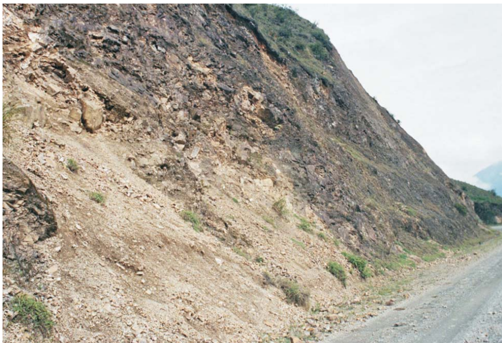
Foto N° 11.21 Derrumbe y caída de rocas que afectan la carretera Zambí Guayquichuma en tramo de 150 m. (S. Núñez, noviembre-2004).
