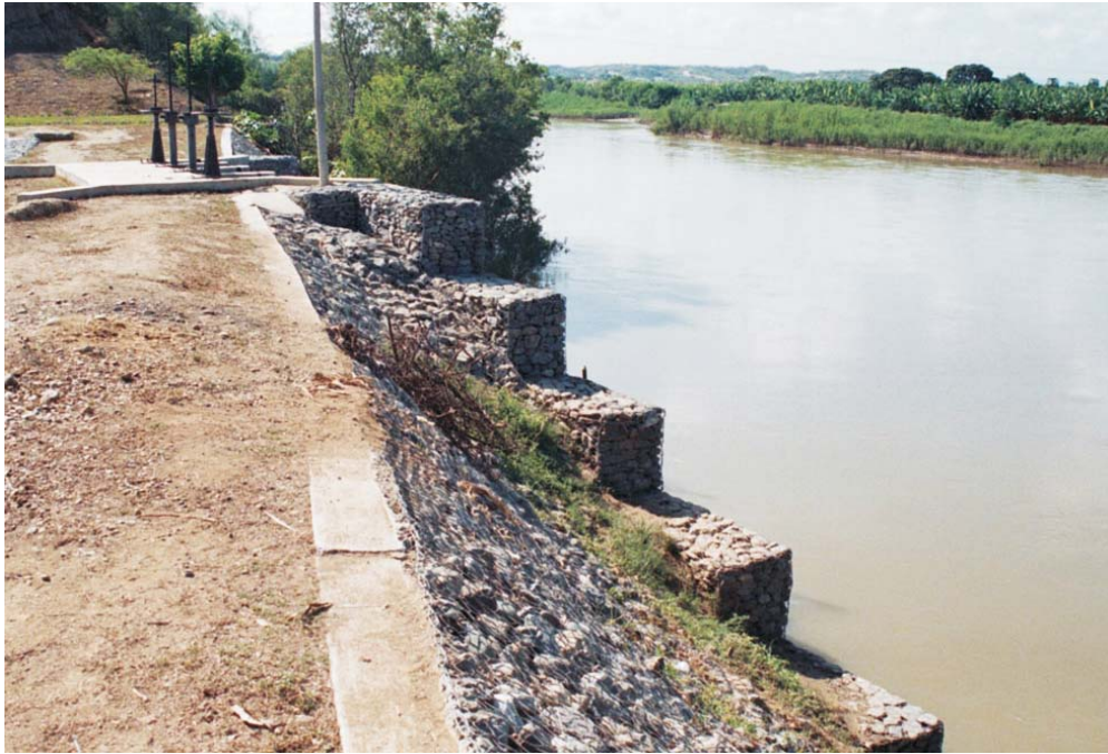
Foto N° 7.23 Erosión fluvial en el sector de Puerto el El Cura, en la vista inferior muestra una protección con gaviones. (S. Núñez, abril-2004).
