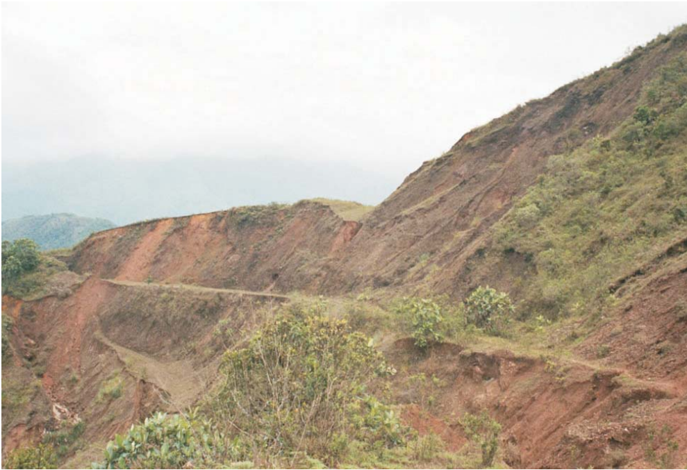
Foto N° 7.3 Deslizamiento traslacional que afectó 100 m de trazo de carretera. El Cisne-Portovelo (a 500 m del sector de los gaviones), actualmente la vía modificó su ruta (S. Núñez, noviembre-2004).
