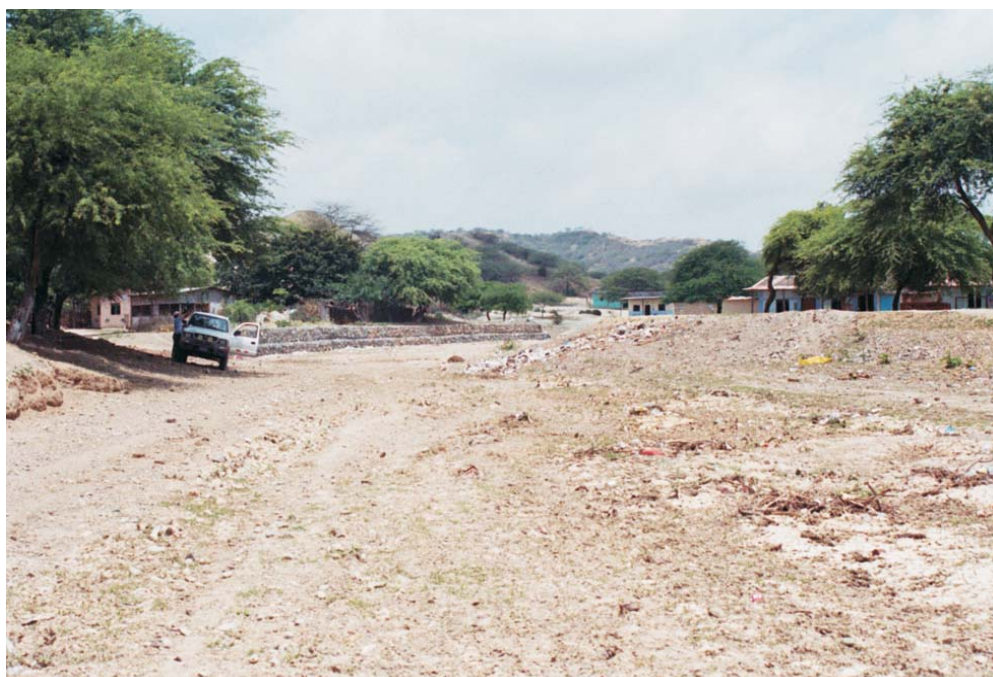
Foto N° 11.6 Quebrada Higuierón canalizada con gaviones, cuando se presenta el fenómeno El Niño se activa afectando viviendas y terrenos de cultivo adyacentes. (S. Núñez, julio-2004).
