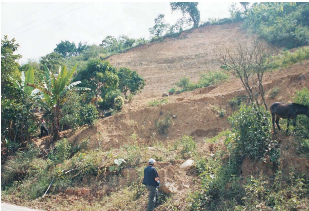
Foto N° 7.6 Deslizamiento traslacional en el sector de Arcapampa, destruyó parte de una vivienda, actualmente todo el talud ha sido removido dándole cierta pendiente (S. Núñez, noviembre-2004).
