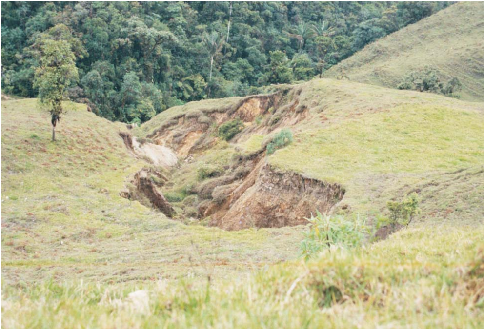
Foto N° 7.15 Erosión en cárcavas que puede afectar la carretera Paccha-Las Torres, se observan pequeños derrumbes y deslizamientos en las paredes de la cárcava. (S. Núñez, noviembre-2004).
