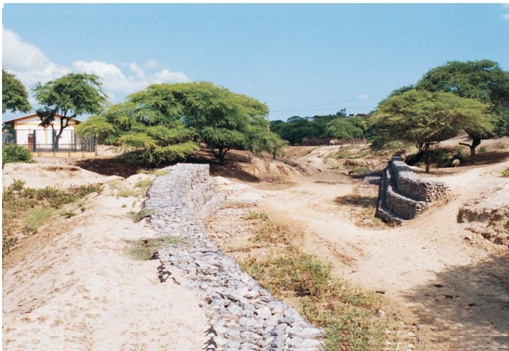
Foto N° 11.3 Sector de Garbanzal, en tiempos del fenómeno El Niño se presentan flujos de lodo que afectan viviendas y carretera de acceso, estas pequeñas quebradas son producto de los fenómenos de erosión en cárcavas. (S. Núñez, mayo-2004).
