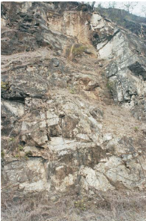
Foto N° 7.18 Caída de rocas, también se pueden generar derrumbes que afectarían en tramo de 150 m la carretera Piñas-Portovelo a la altura del km 8+070. (S. Núñez, Noviembre-2004)
