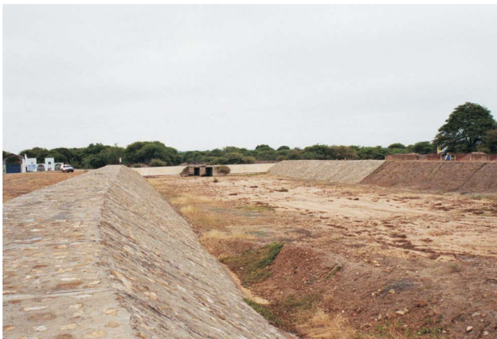
Foto N° 7.14 Quebrada amplia, que se activa solamente cuando se producen lluvias excepcionales, puede afectar la Carretera Panamericana Norte, en la margen derecha se debe culminar la obra de protección. (S. Núñez, mayo-2004).
