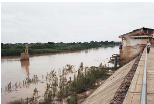
Foto N° 11.12 Vista del cauce del río Tumbes, donde en la margen izquierda se distingue un pilar abandonado, parte del antiguo puente Tumbes. En la margen derecha, la ciudad de Tumbes está protegida por muros de concreto. En este lugar se presentan fenómenos de erosión fluvial. (S. Núñez, abril-2004).
