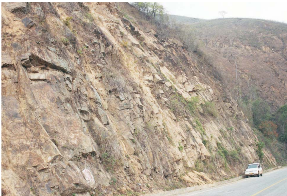
Foto N° 11.28 Carretera Pindo-Loja (km 60+910), muestra de roca metamórfica fracturada, que en tiempo de lluvias genera caída de rocas, pudiendo también presentar derrumbes. (S. Núñez, noviembre-2004).
