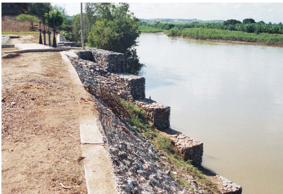
Foto N° 11.11 Defensas ribereñas ubicadas en la margen derecha del río Tumbes, protegiendo la toma de agua del puerto El Cura. (S. Núñez, abril-2004).
