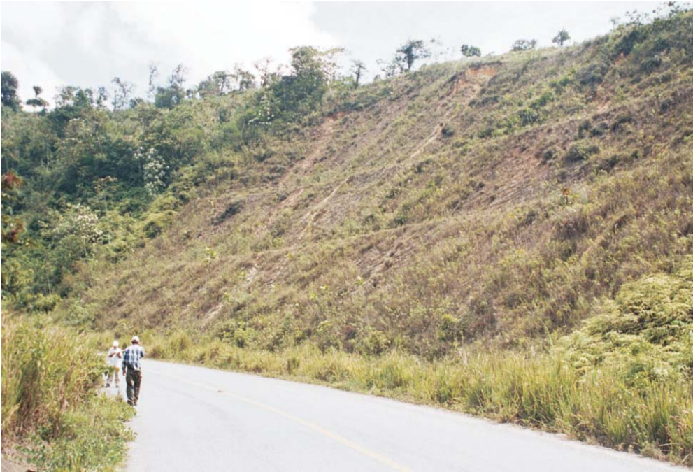
Foto N° 7.7 Sector de la carretera Balsas-Pindo altura de San José, zona de derrumbes, talud banqueteado (S. Núñez, noviembre-2004).
