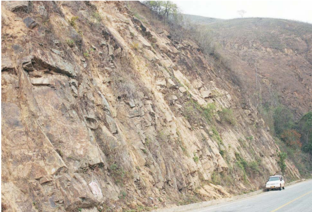
Foto N° 7.17 Caída de rocas, afectan tramo de 200 m de carretera Pindo-Loja, km 60+910. (S. Núñez, Noviembre-2004).
