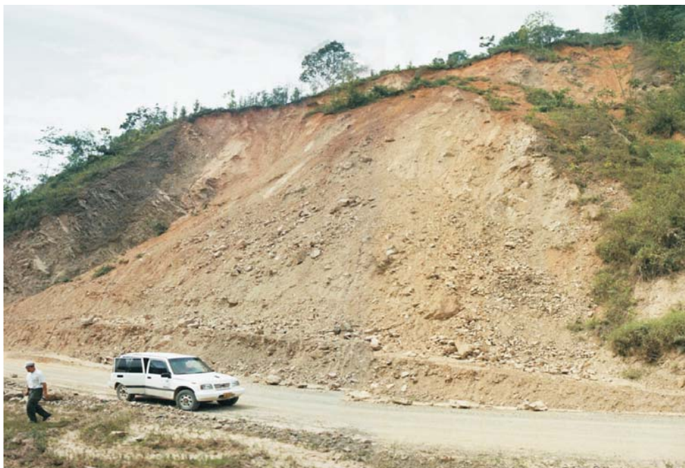
Foto N° 7.5 Parte de un deslizamiento traslacional que está afectando la carretera Piñas-Loja y puede generar derrumbes (S. Núñez, noviembre-2004).
