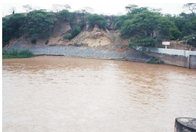
Fotos N° 11.13 Vistas de la bocatoma La Peña, ubicada en la margen izquierda del río Tumbes, susceptible a erosión fluvial, como medidas de protección se le han colocado gaviones. (S. Núñez, julio-2004).
