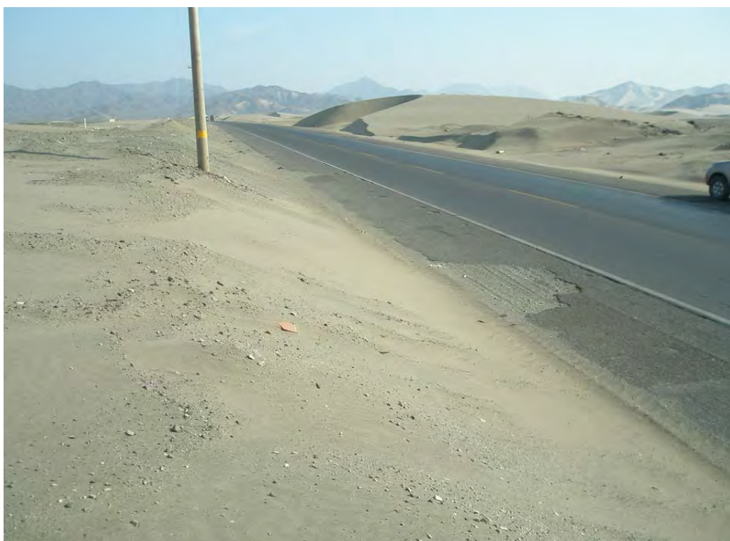
Fotografía 7.18 Mantos de arena que afectan la carretera de acceso por la Panamericana Norte. Altura del km 491. Sector Pampa Los Pancitos, distrito de Chao, provincia Virú.
