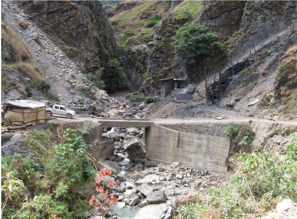
Fotografía 9.7 Derrumbe entre las quebradas Lirios y Ciénegos, distrito Huaranchal, provincia Otuzco. Afecta carretera de acceso a Huaranchal.
