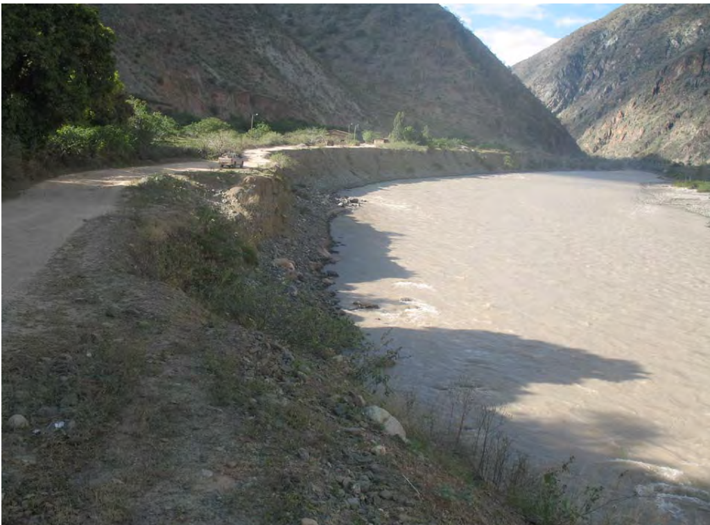
Fotografía 7.13 Erosión fluvial en la margen derecha del río Marañón. Afecta la plataforma de la carretera afirmada Chagual-Pías.
