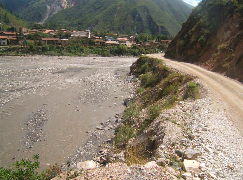
Fotografía 7.12 Erosión fluvial en ambas márgenes del río Chusgón (caserío Pallar), distrito Huamachuco, provincia Sánchez Carrión. Durante el fenómeno El Niño, de 1997 a 1998, la erosión fluvial afectó la carretera afirmada de acceso a Tayabamba y destruyó la mitad de las viviendas del centro poblado El Pallar.
