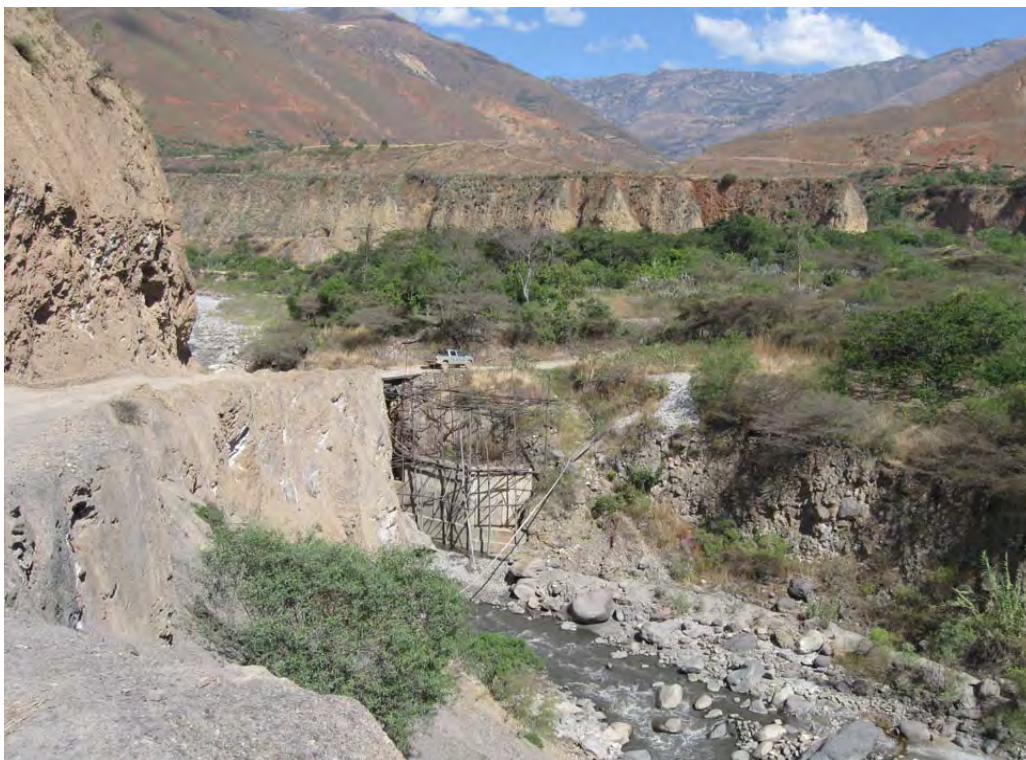
Fotografía 9.8 Erosión fluvial en ambas márgenes de la quebrada Charat, distrito de Huaranchal, provincia Otuzco. Se observa un puente aproximadamente de 20 m de luz abandonado a media construcción.
