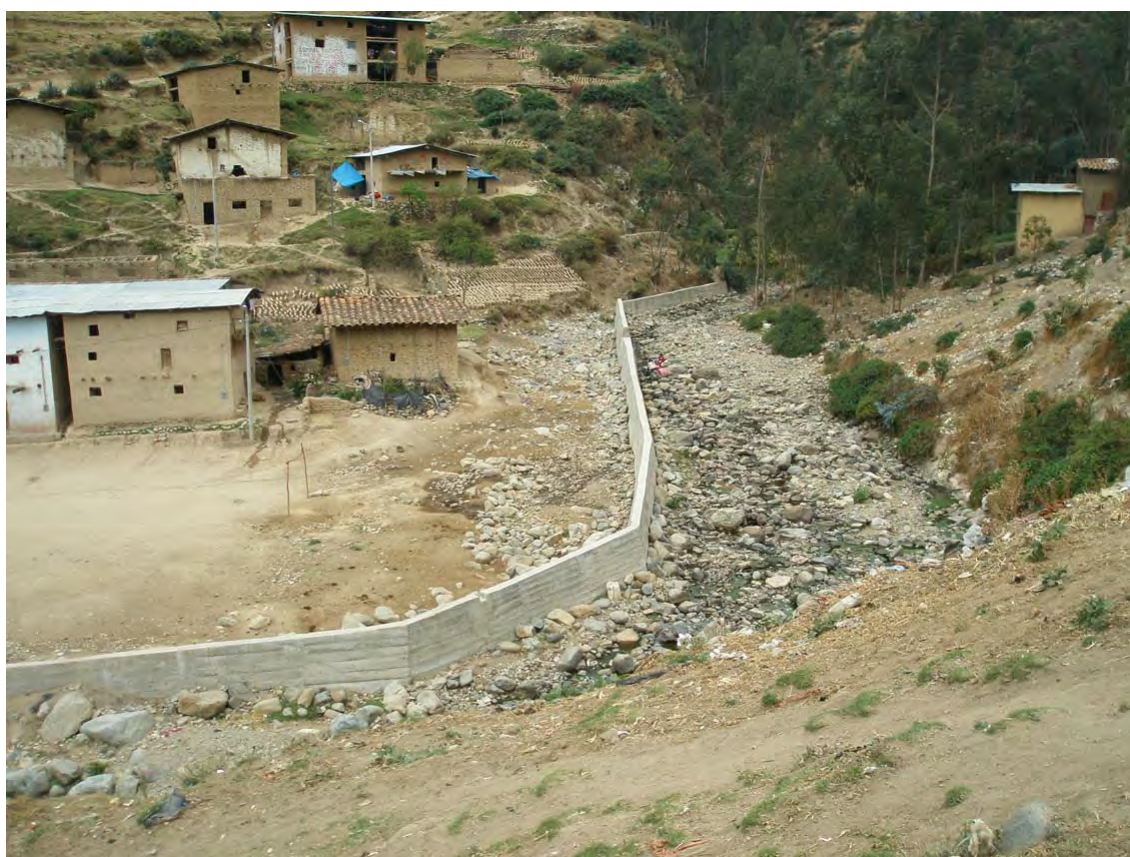
Fotografía 9.17 Área susceptible a procesos de erosión fluvial en ambas márgenes del río Santa Lucía, sector San Ignacio. Como medida de protección, se ha construido un muro de concreto que invade el cauce de río, el cual se debe modificar, ya que está sujeto a erosión y posterior colapso.
