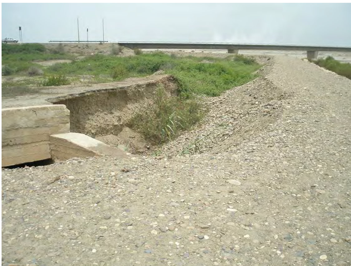
Fotografía 7.14 Erosión fluvial en la margen izquierda del río Chicama. Afectó la plataforma asfaltada de la carretera Panamericana Norte.
