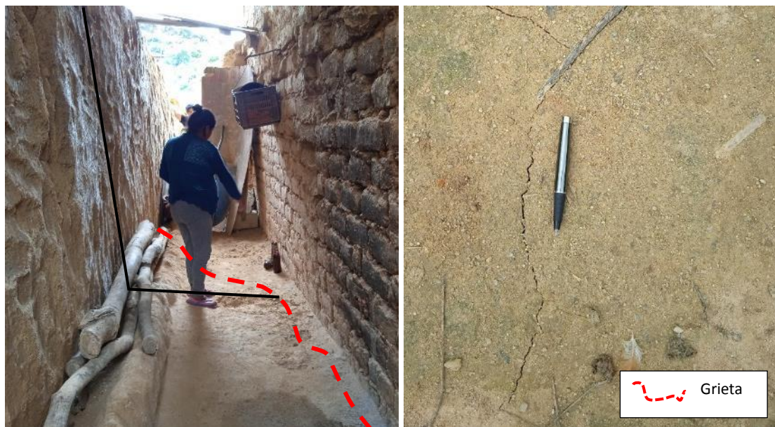
Figura 17. Grietas observadas en el interior de las viviendas, coordenadas 9447643N y 647400E.
