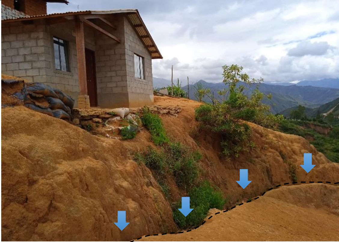
Figura 37. Zanja no revestida para drenar el agua de escorrentía en el AA.HH. Sagrado Corazón de Jesús, coordenadas 9447431N y 647787E.
