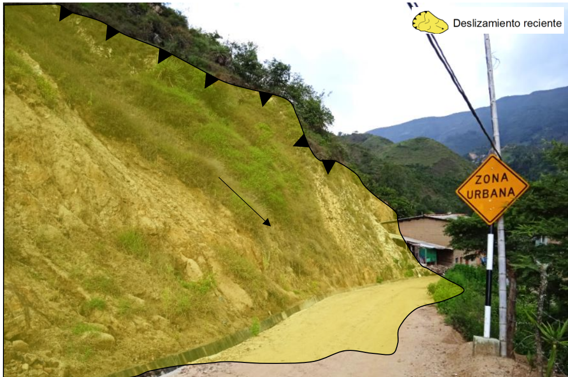
Figura 25. Escarpe principal del deslizamiento que afecta viviendas ubicada en la calle Villa Deportiva, coordenadas 9447863N y 647339E.
