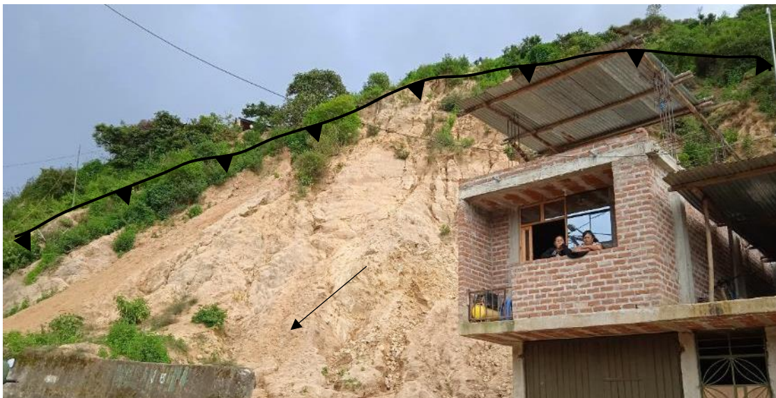
Figura 19. Vista frontal desde la calle La Unión donde 5 viviendas fueron afectadas por el deslizamiento.
