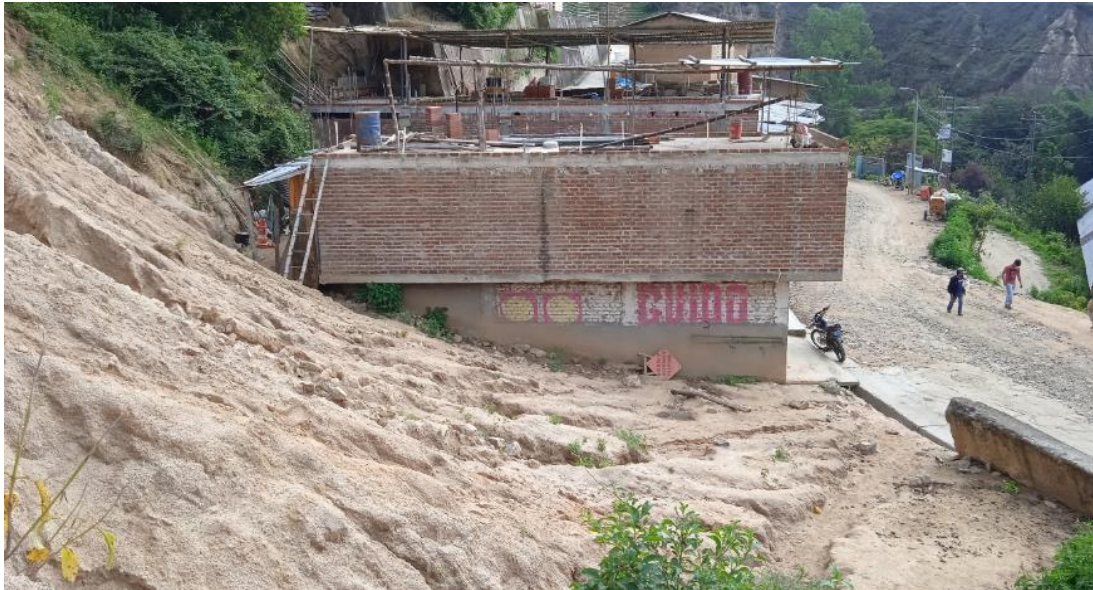
Figura 38. Viviendas ubicadas en la calle La Unión afectadas por deslizamiento.
