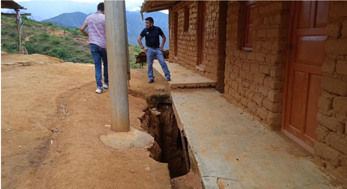
Figura 41. Vivienda afectada por cárcavas. Coordenadas 9493022N y 633362E.
