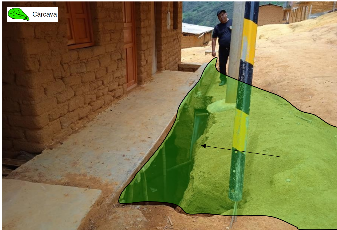
Figura 22. Vivienda afectada por procesos de erosión en las coordenadas 9447405N y 647751E.
